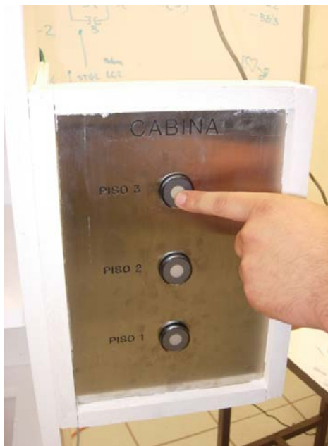
Figura 4.9 Se presiona el botón de cabina para ascenso al tercer nivel
