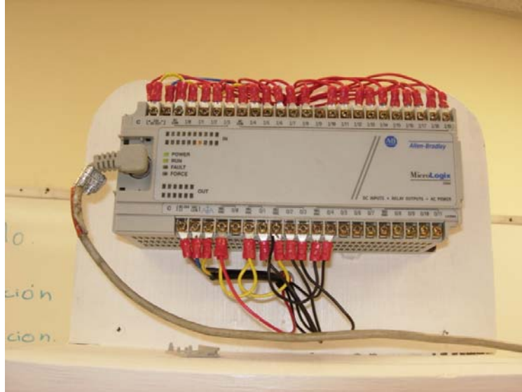
Figura 4.14 El PLC está en zona de puertas del tercer nivel
