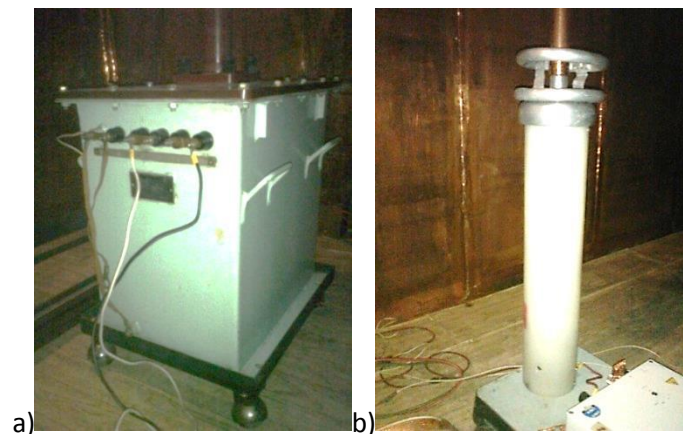
Figura 4.5. a) Transformador de alimentación, b) Capacitor de acoplamiento empleado.
