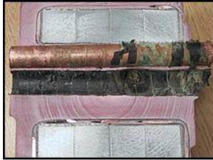
Figura 18 Ejemplo de una descarga interna en un transformador de corriente seccionado
