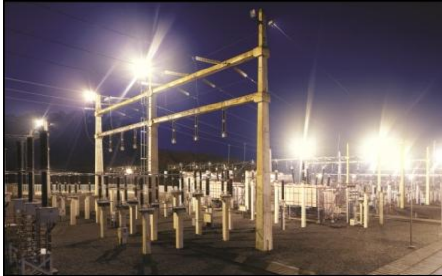
Figura 10 Ejemplo de una subestación aislada en intemperie.
