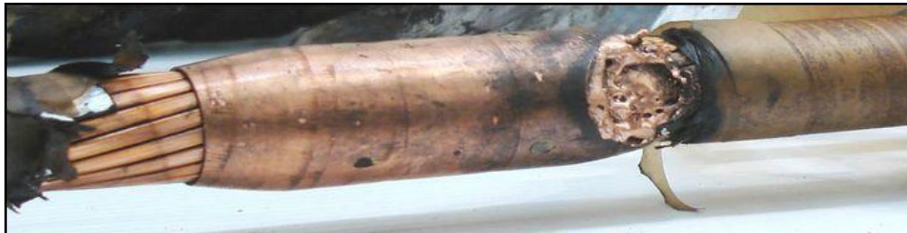
Figura 20 Ejemplo de una falla por corto Circuito
