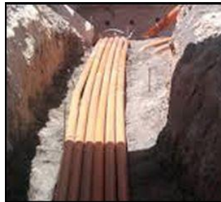
Figura 14 Ejemplo de canalización de ductos
