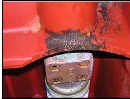
Figura 17 Ejemplo de descarga parcial superficial sobre un carro de interruptor
