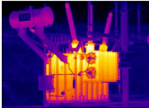
Figura 25 Ejemplo de una Termografía de un Transformador
