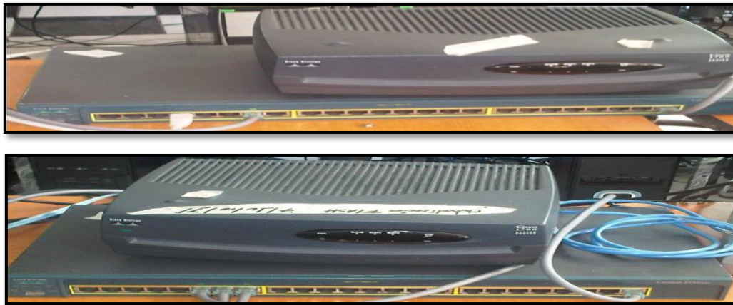
Fig. (5.12)Equipo utilizado router CISCO Modelo 1751 y Switch CISCO Catalyst 2950 para Red B y Red C
