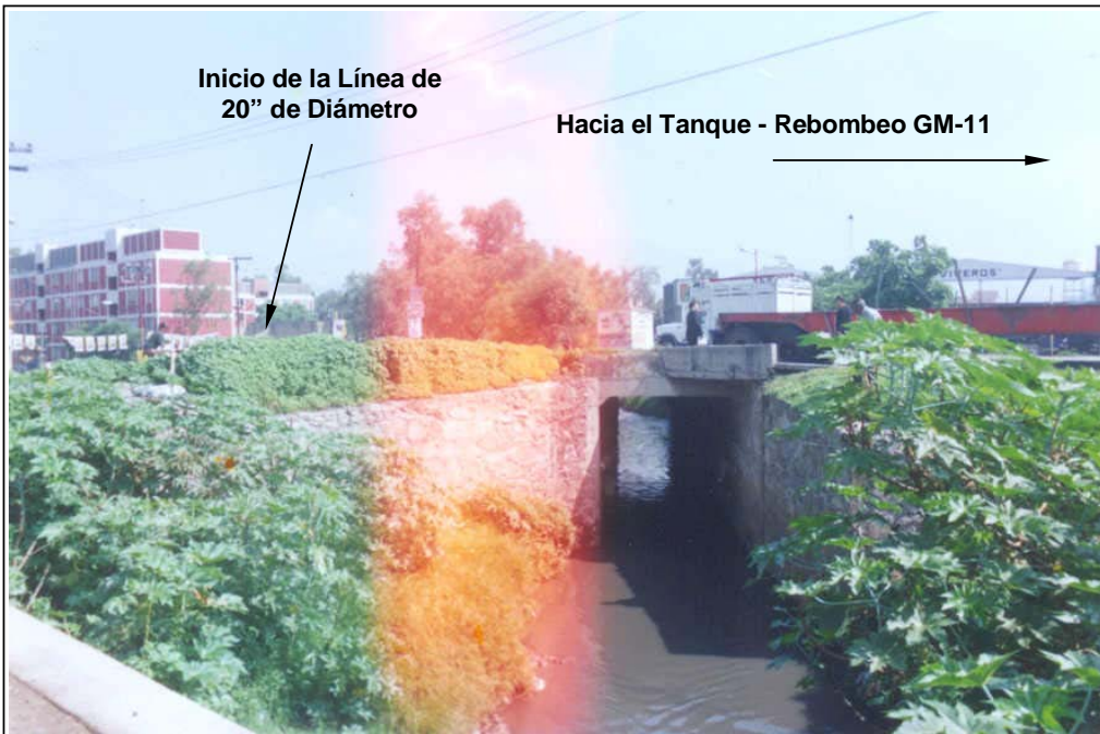
Fotografía 5 Alcantarilla en el Río San Javier para el Cruce de Bulevar del Temoluco, Vista de Sur a Norte
