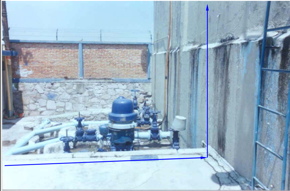
Fotografía 29 Llegada al Tanque - Rebombéo GM-11 para las Alternativas #1, #2 y #3
