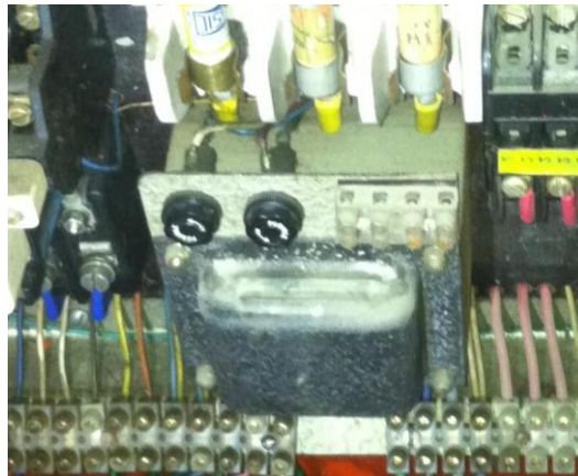
Figura 2.7 Transformador del telar hilador
