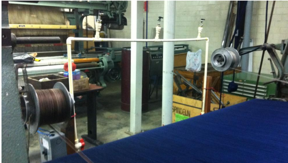
Figura 5.9 Vista de los rociadores con respecto al telar
