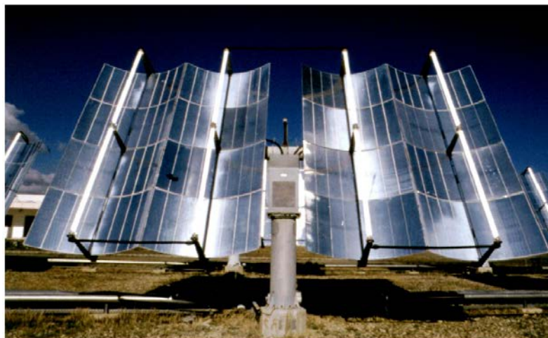
Figura 14. Colector cilindro-parabólico con seguimiento de dos ejes instalado en la Plataforma Solar de Almeria, PSA, España
