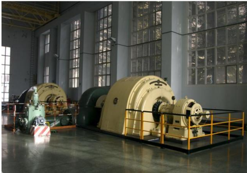
Fig. 1.2 cuarto de máquinas de una central.
