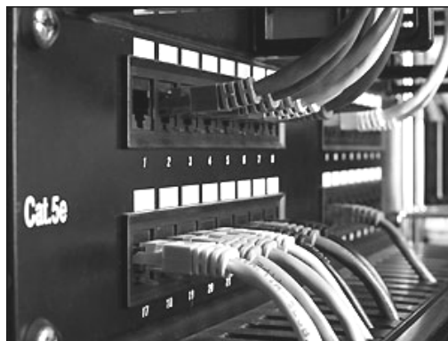
Figura 1.7 Panel de parcheo de la categoría 5e con cables de parcheo
