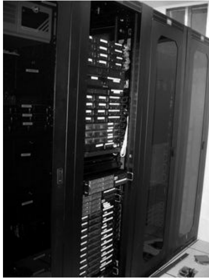
Figura 1.13 Rack para servidores
