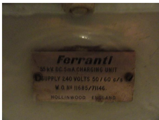
Figura 4.5 - Datos de placa del control de tensión en C.A y rectificación.
