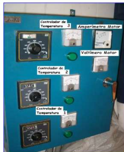
Figura 13 Tablero de control de temperatura de máquina inyectora.
