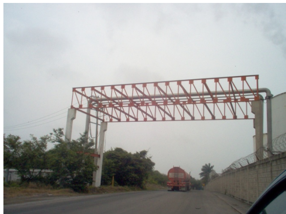
Imagen 4. Tuberías para el transporte de vapor residual desde INSA-NHUMO hasta industria Mexichem.
