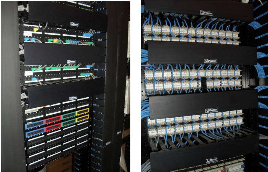
Figura 3.6. Paneles de parcheo de una red convergente con cableado estructurado.
