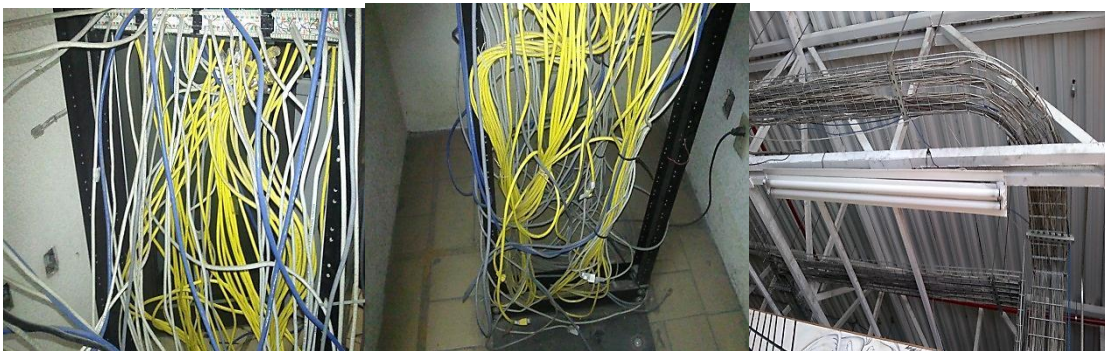
Figura 5.19 Cableado actual del rack y las escalerillas de la Secretaria de Turismo.
