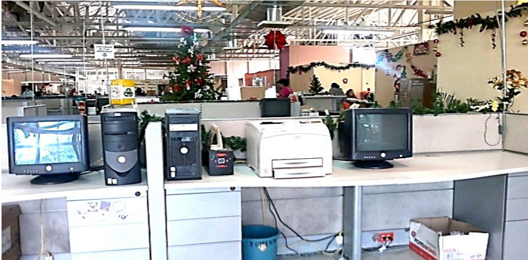
Figura 5.3 Equipo y cableado en techo.
