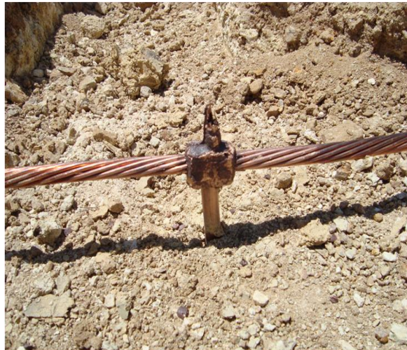
FIGURA 4.2 Conexión de la varilla cooperweld al cable de cobre.
