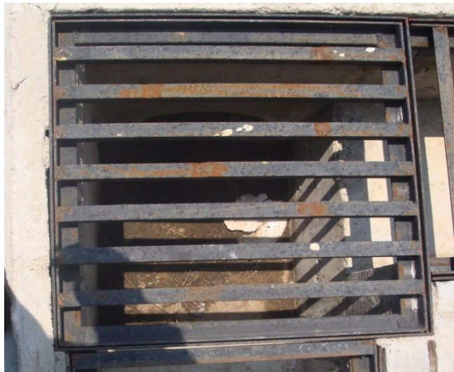
FIGURA 4.5 Registro para captación de aceite.
