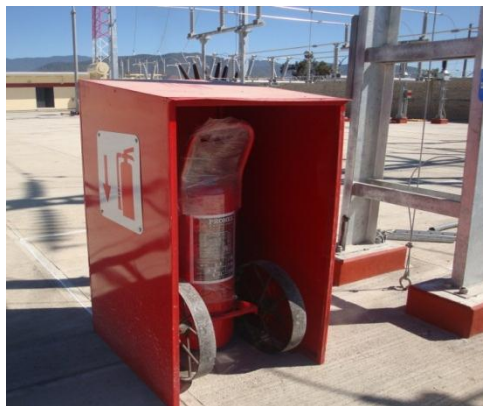
FIGURA 4.6 Equipo extintor móvil
