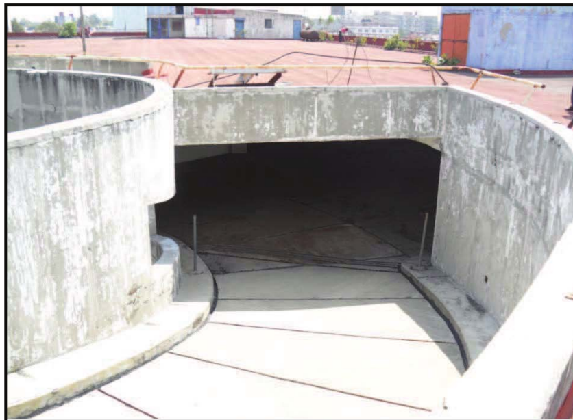
FOTOGRAFIA No. 08: Detalle de la zona de acceso al estacionamiento al descubierto en la azotea del edificio.
