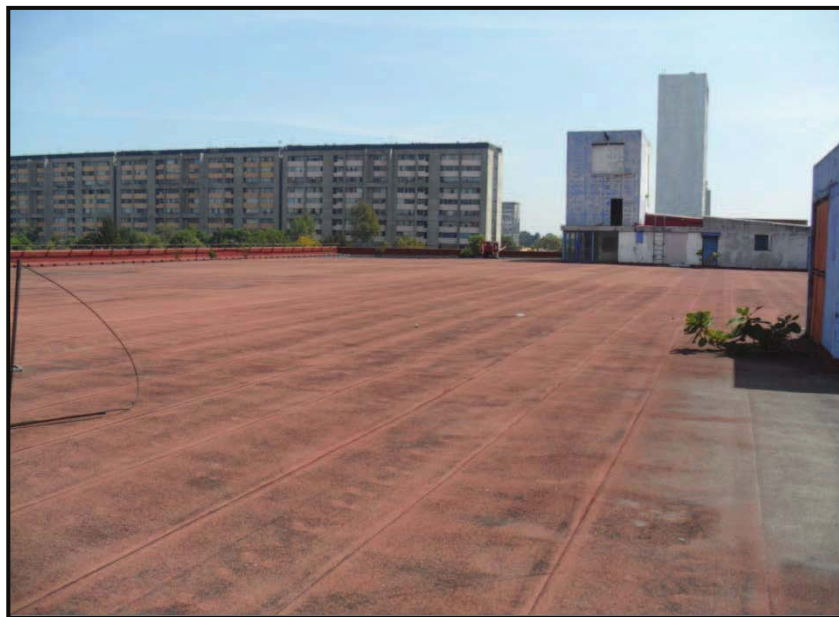
FOTOGRAFIA No. 12: Panorámica del estacionamiento de la azotea, su impermeabilización acusa que nunca fue usado como tal, ya que no es apropiado para el rodamiento
