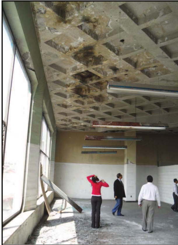
FOTOGRAFIA No. 07: Aspecto del entrepiso de la planta alta, se observan algunas humedades en la proximidad de la fachada posterior
