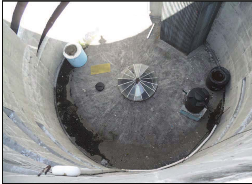
FOTOGRAFIA No. 11: La parte central del acceso al estacionamiento está cubierto por una losa que permite su uso en la planta alta como puede verse
