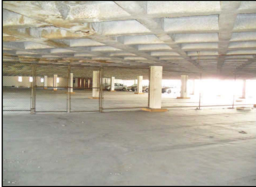
FOTOGRAFIA No. 09: La altura de los dos niveles de estacionamiento inferiores a la azotea es menor a la que actualmente se tiene en el Reglamento de Construcciones del D.F.
