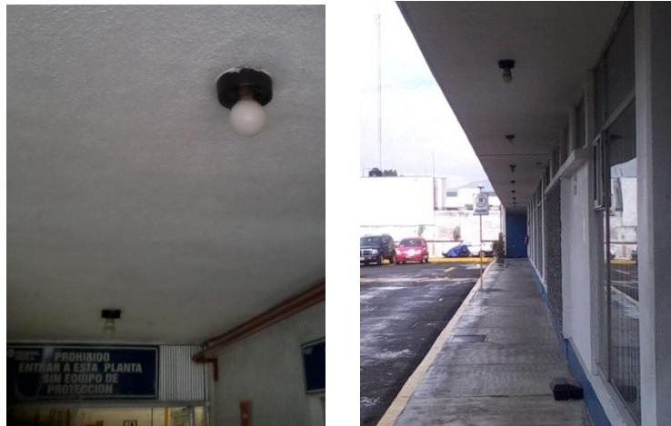
Fig. 4.2.5. En el pasillo exterior tienen instaladas lámparas tipo esfera aperlada incandescentes y fluorescentes. Fuente: Elaboración Propia.
