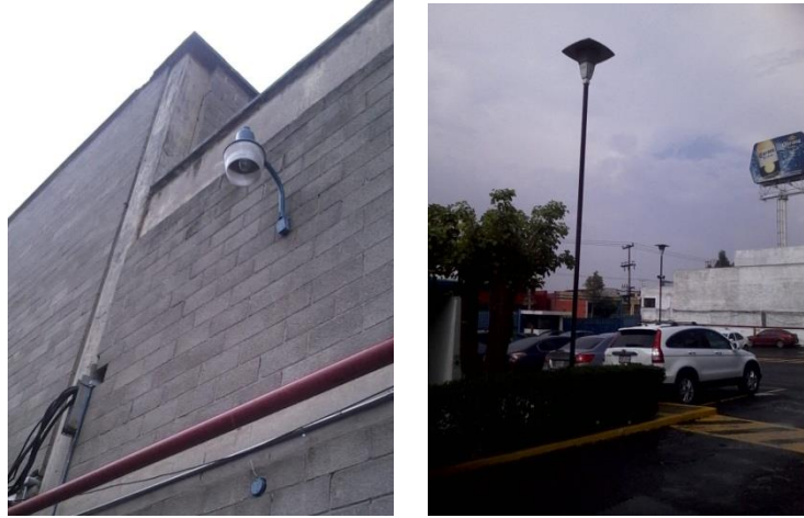
Fig. 4.2.6.. El alumbrado exterior consta de lámparas de aditivos metálicos de 175W (en luminarios suburbanos) y de 400W (en postes). Fuente: Elaboración Propia.
