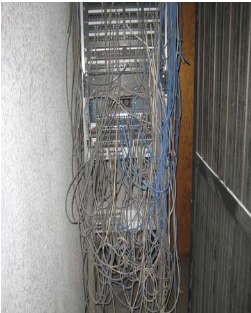
Fig. 4.1 Equipo de Comunicaciones Rodano 2º piso
