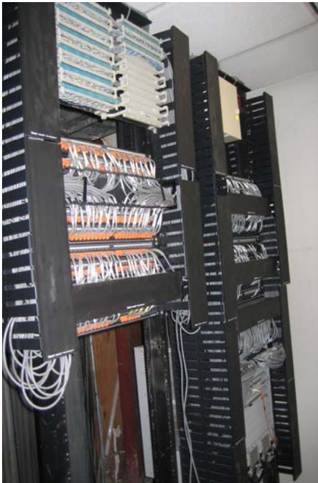
Fig.4.3 Equipo de Coms. Reforma 5º piso
