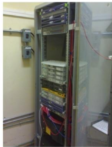
Fig.38.- Rack de comunicaciones
