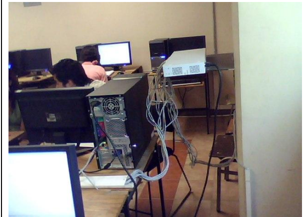
Fig. 56.- Canaleta encima de las mesas de los usuarios
