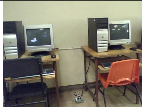
Fig.58.- Terminaciones eléctricas en el área de trabajo
