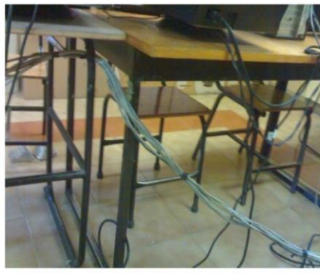
Fig. 55.- Mala distribución de cables
