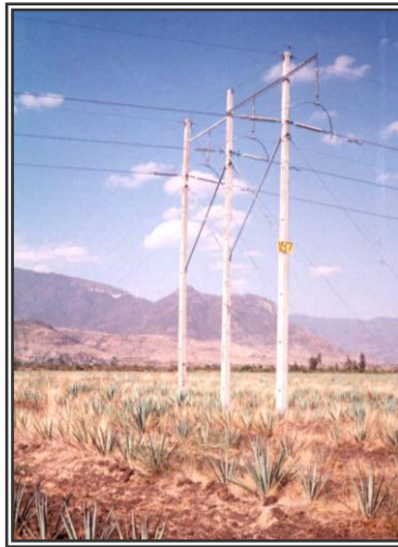
Figura 4. Línea de distribución de 13.8 KV con postes de concreto.
