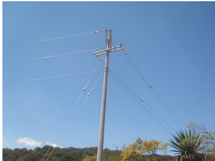
Foto: retenida doble ancla
