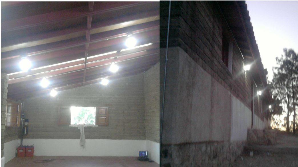
Fig. 4.16 Sistema Fotovoltaico en Operacion.
