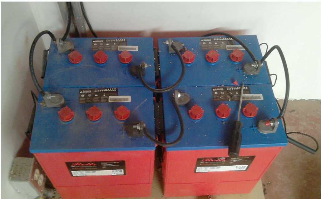
Figura 4.1 Banco de baterías de 520 Ah
