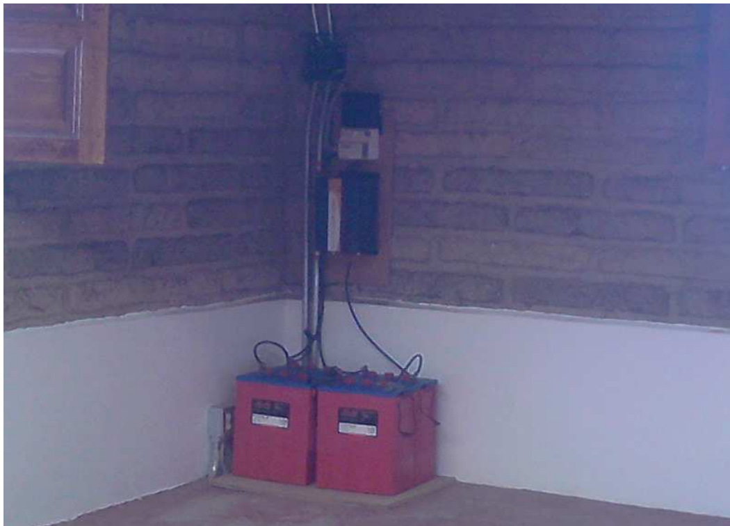
Fig. 4.15 Sistema Fotovoltaico Instalado y Conectado.
