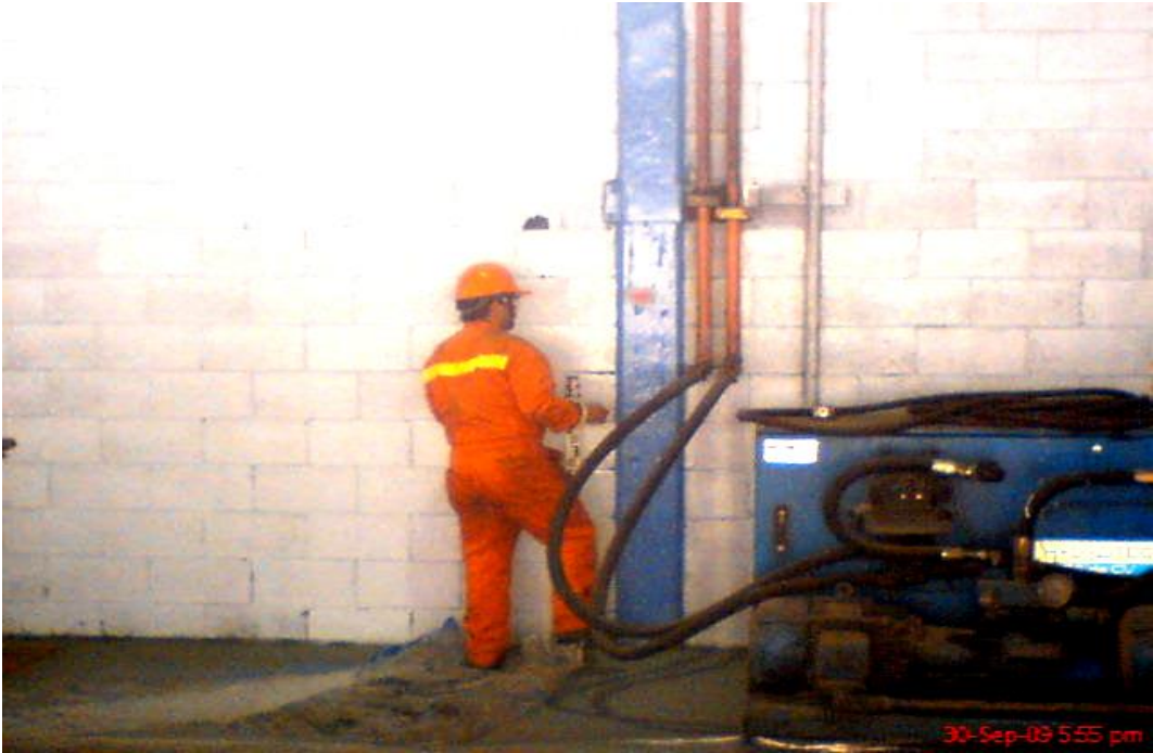
Figura 11. Muestra el lugar donde se colocó la referencia a 1.45 metros del piso.
