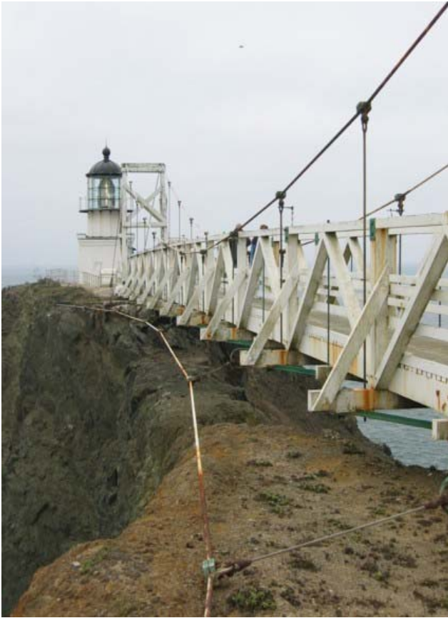
Foto 1.3-44 Detalle de la red de cable unida a las vigas para estabilizar al puente
