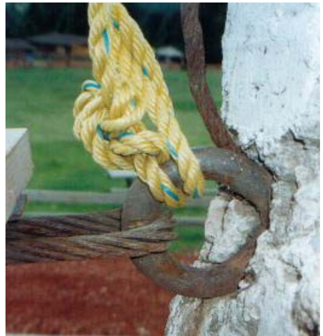
Foto 2-12 Unión de los cables principales por medio de una argolla anclada a los apoyos de concreto
