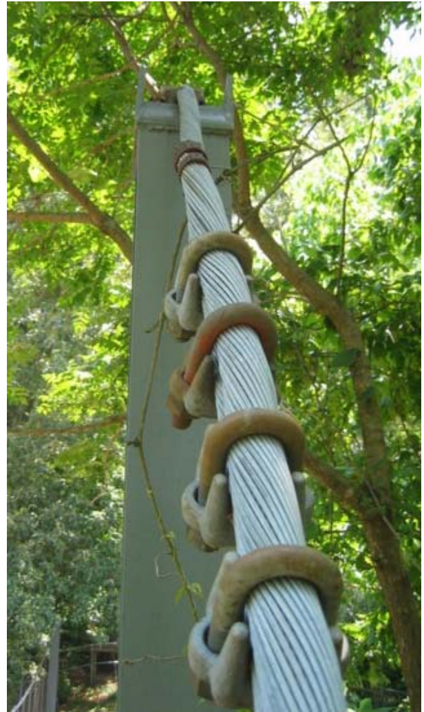
Foto 1.3-36 Detalle de la unión del cable principal con la columna de acero
