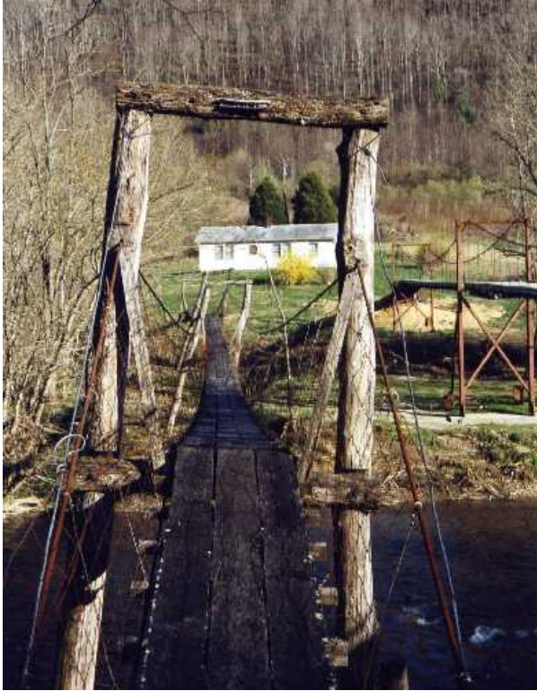
Foto 1.3-18 Vista frontal del puente destruido por los efectos del intemperismo
