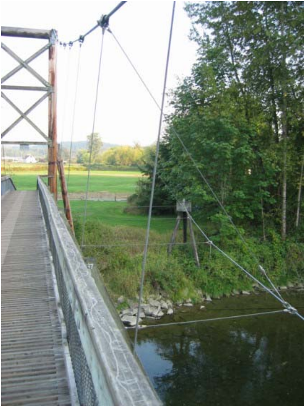
Foto 1.3-12 Detalle de la unión de la red de cables con el elemento independiente que estabiliza el puente
