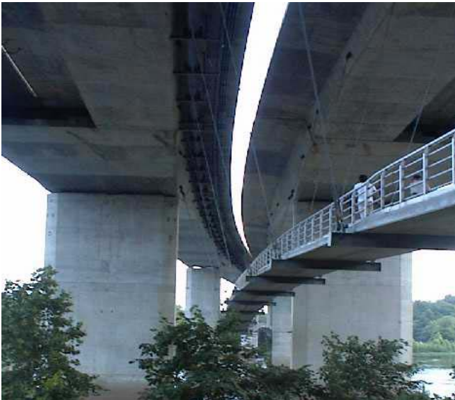
Foto 1.3-2 En esta fotografía podemos ver que los cables que soportan al puente peatonal se encuentran anclados en la parte posterior de la losa del puente vehicular
