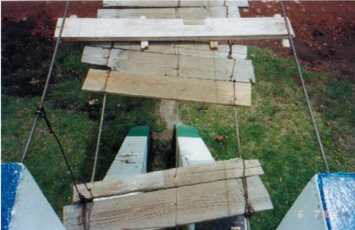
Foto 2-18 Estado en el que se encuentran los elementos estructurales que conformaban el acceso al puente
