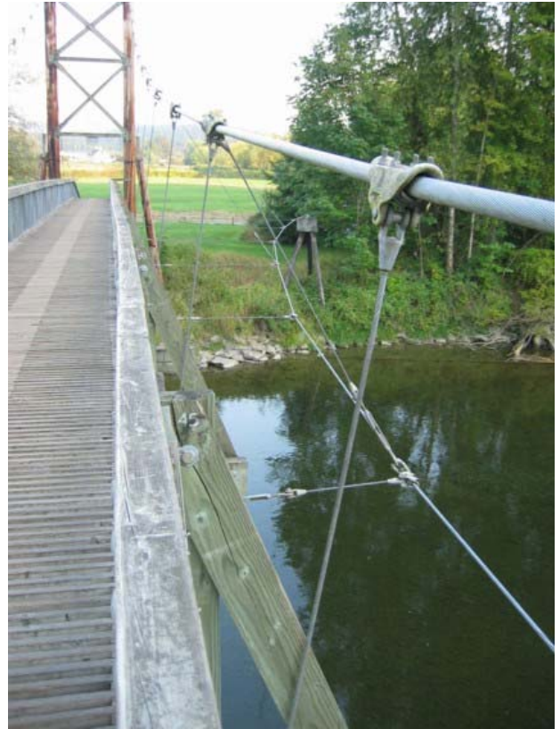
Foto 1.3-13 Ubicación general de la red de cables y su unión con la estructura estabilizadora
