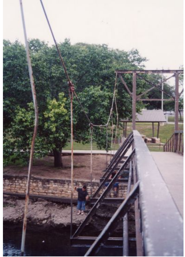
Foto 1.3-105 Detalle de los tubulares verticales y su posición con respecto a las vigas y al barandal
