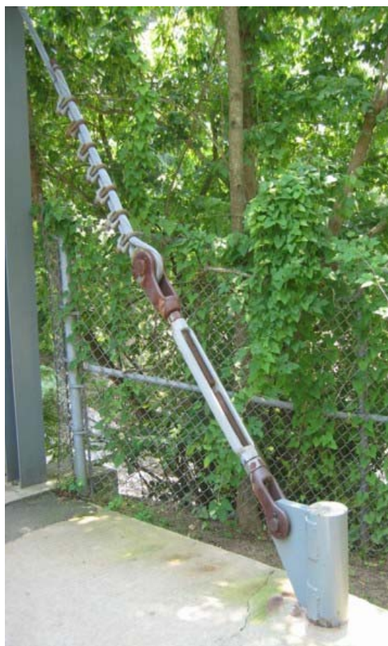
Foto 1.3-32 Sistema de templadores para proporcionar mayor estabilidad al puente
