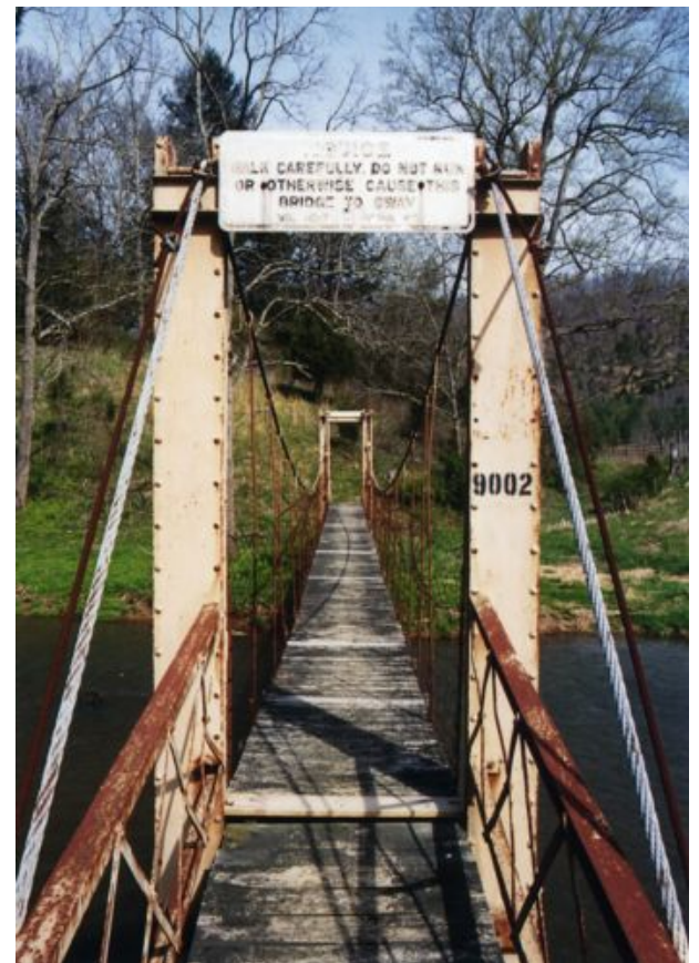
Foto 1.3-69 Diseño de los pórticos de acero y detalle del acceso al puente
