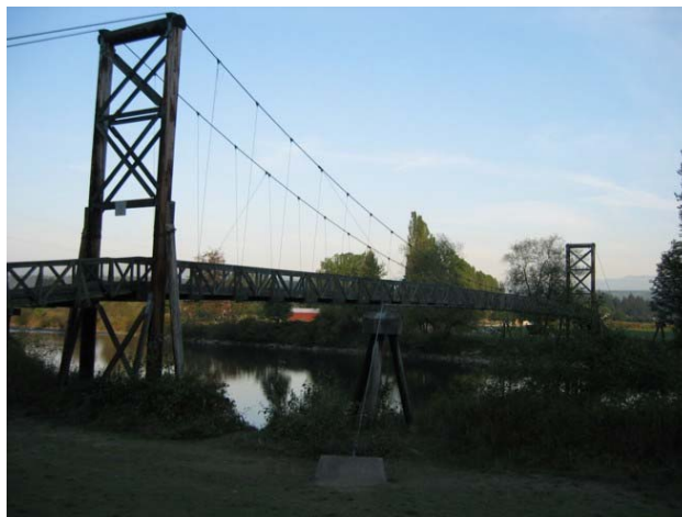
Foto 1.3-15 Vista lateral en la que se puede apreciar la estructura independiente que permite dar mayor estabilidad al puente
