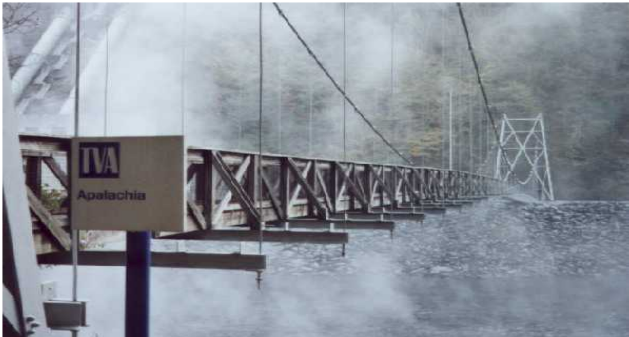
Foto 1.3-89 Vista de la caída de agua que moja la estructura del puente
