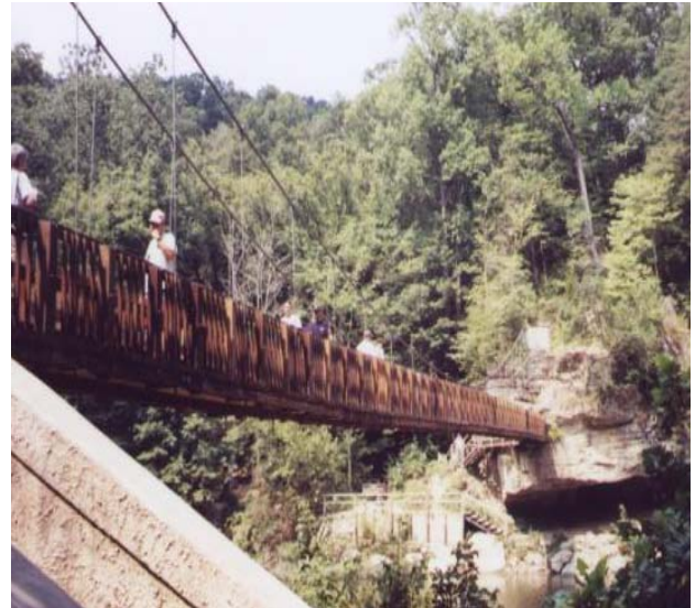
Foto 1.3-64 Posición de las vigas a lo a lo largo del puente y del anclaje del piso en roca firme
