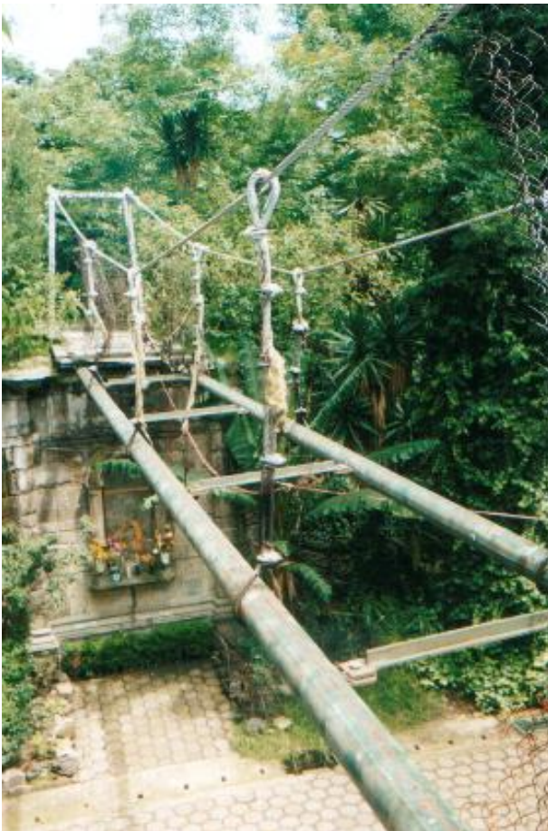
Foto 2-14 Detalle de los materiales utilizados en la construcción y su colocación a lo largo de la estructura, observando su grave deterioro
