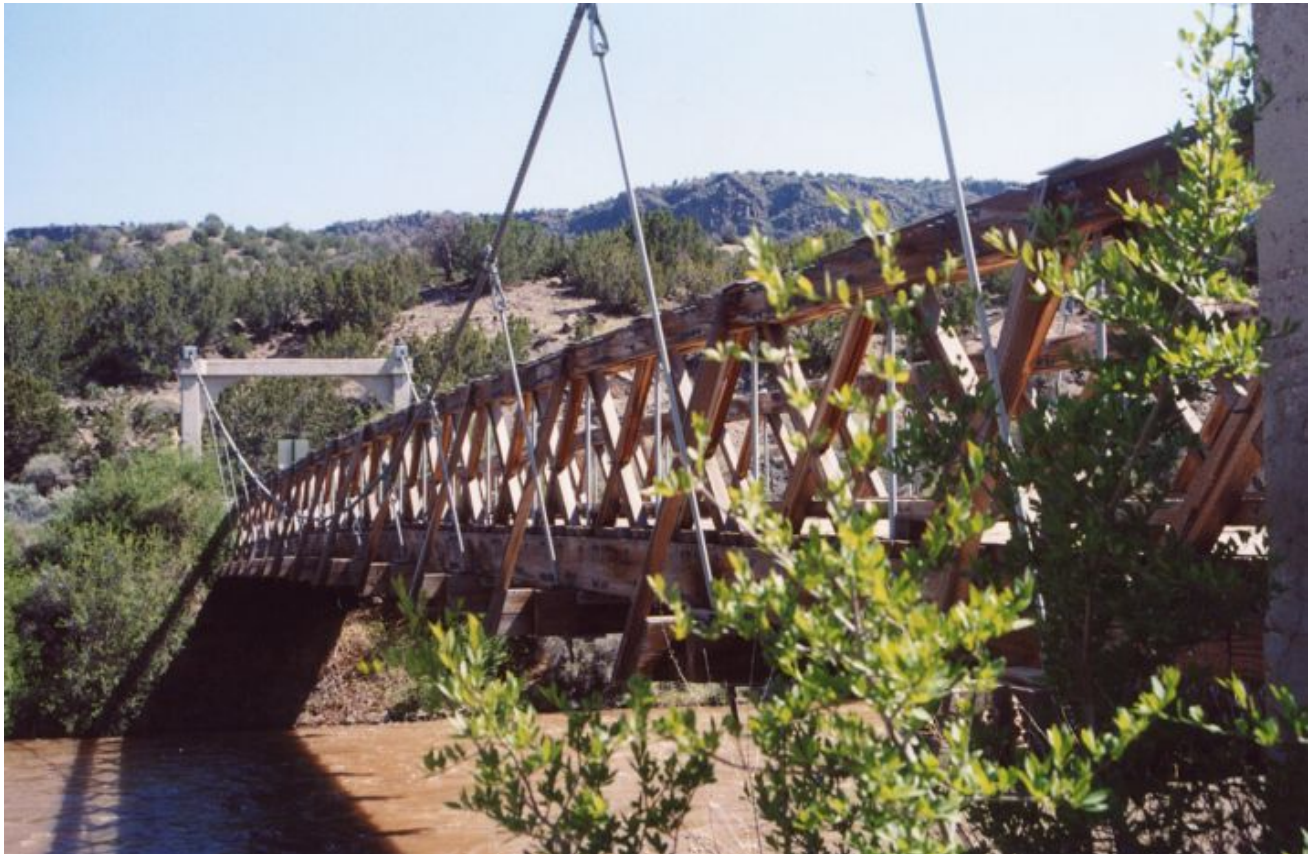
Foto 1.3-111 Vista lateral que muestra la unión de los redondos verticales con los cables principales y la viga
