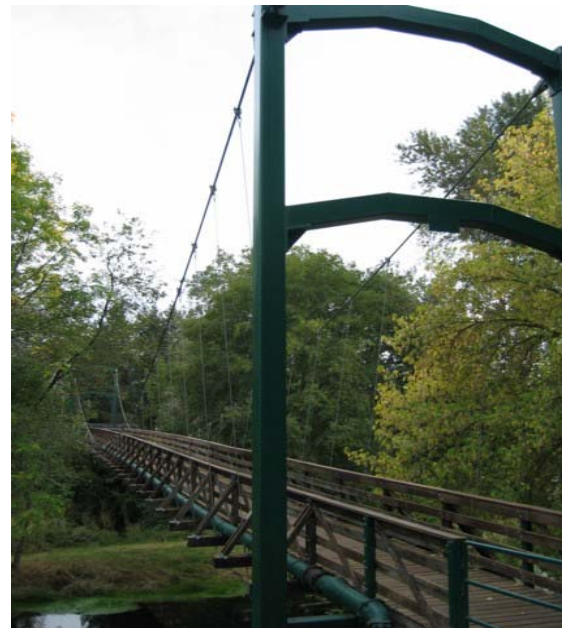
Foto 1.3-51 Detalle de la posición de la tubería por encima de las vigas inferiores
