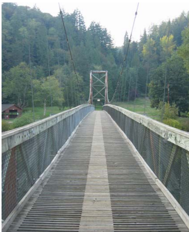
Foto 1.3-9 Posición de los cables verticales con respecto a la posición del barandal y de los cables superiores
