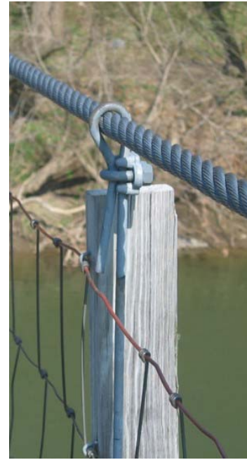
Foto 1.3-57 Unión del cable vertical con el principal por medio de perros
