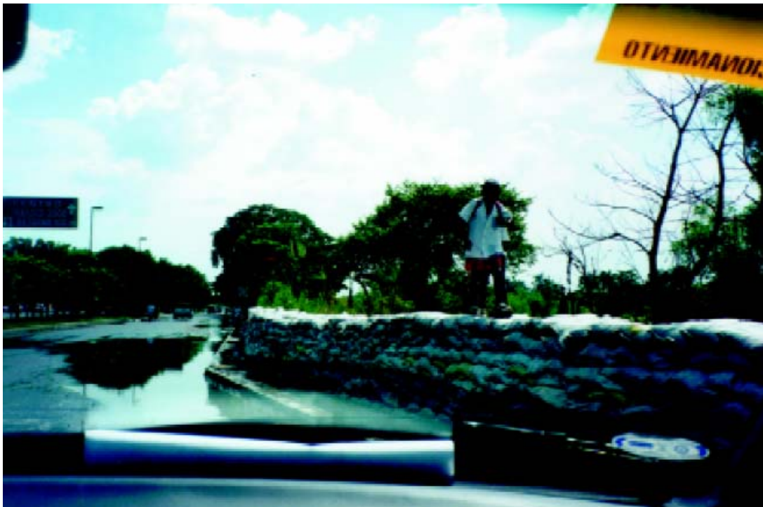
Foto 2-21 Obra de protección provisional en Villa Hermosa, Tabasco durante las inundaciones de 1999
