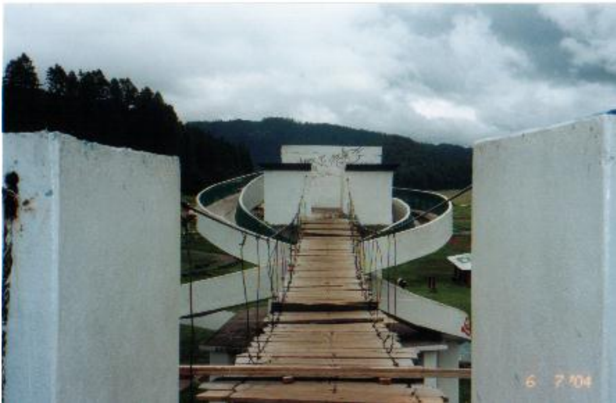
Foto 2-17 Estructuración general del puente del Valle del Silencio que permite el acceso al tobogán y podemos apreciar el deterioro que ha sufrido la estructura a través del tiempo
