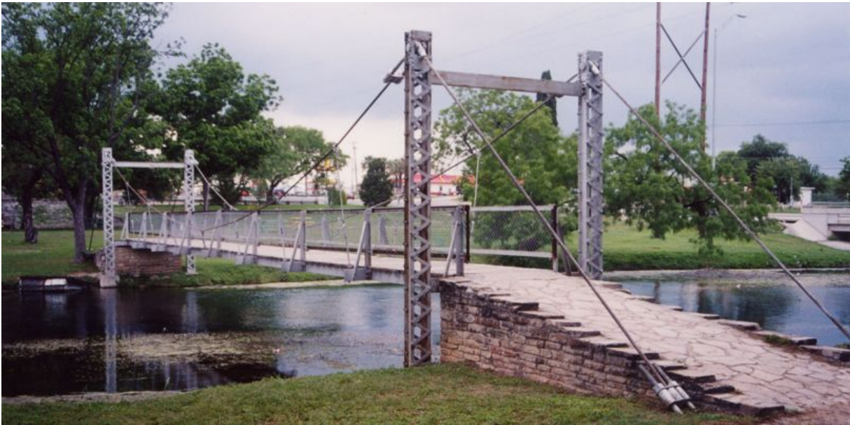
Foto 1.3-96 Vista general del puente en la que se pueden apreciar cada uno de los elementos que lo componen
