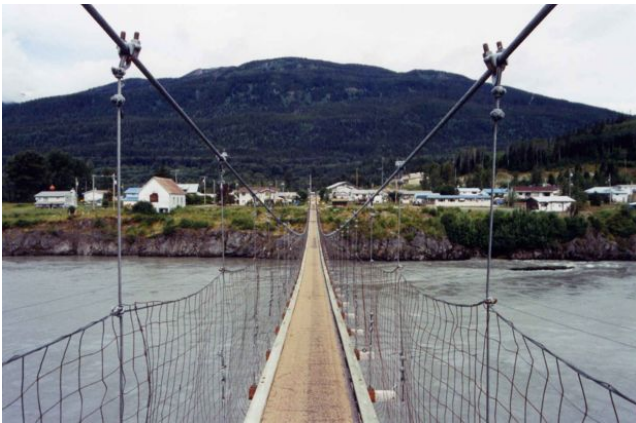
Foto 1.3-74 Vista de la unión de los cables verticales con la malla ciclónica
