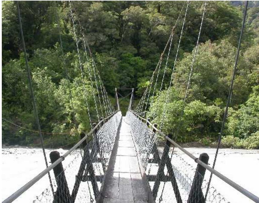
Foto 1.3-94 Sistema de barandal a base de tubulares y malla ciclónica a lo largo del puente
