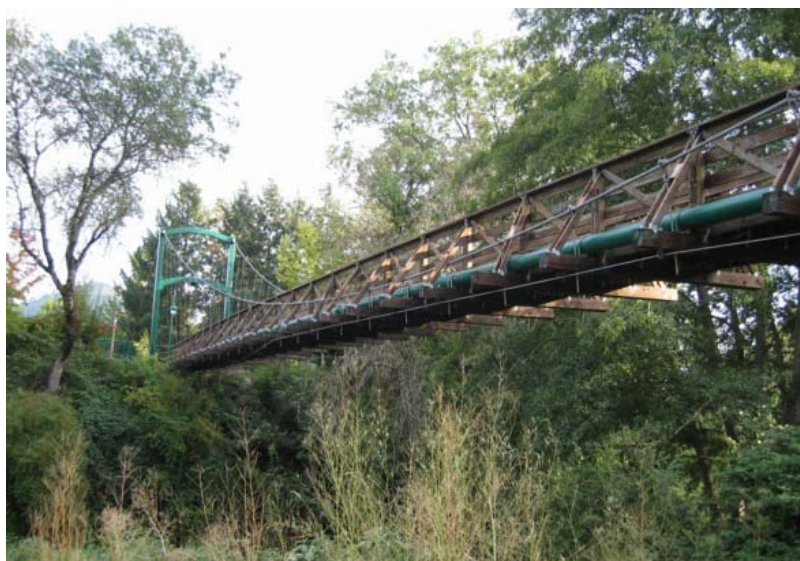
Foto 1.3-54 Detalle de los contraventeos a lo largo del barandal de madera
