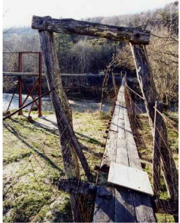
Foto 1.3-19 Ausencia de estabilidad en los pórticos del puente viejo
