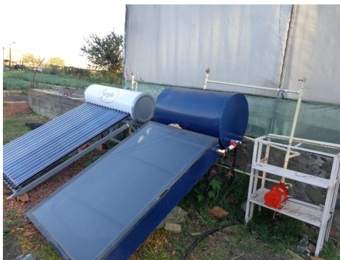
Figura 4. Sistema de calefacción, parte externa
