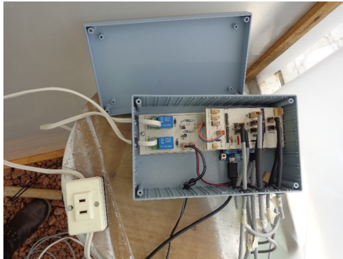
Figura 9. Vista superior del Microcontrolador Arduino y circuitos periféricos para la medición de temperatura y control de la bomba de agua.
