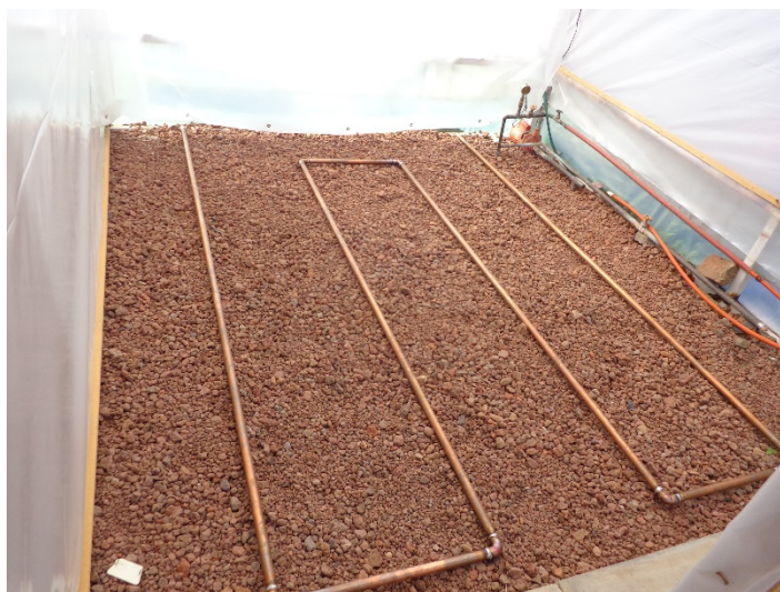
Figura 5. Sistema de calefacción, parte interna
