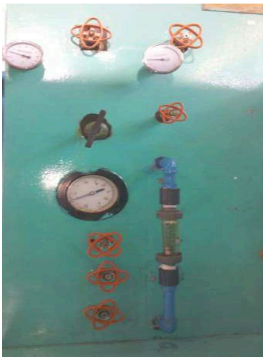
Figura 3.19. Válvulas de alimentación al equipo.
