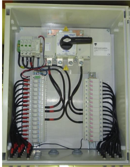
Figura 3.3 Caja de conexiones
