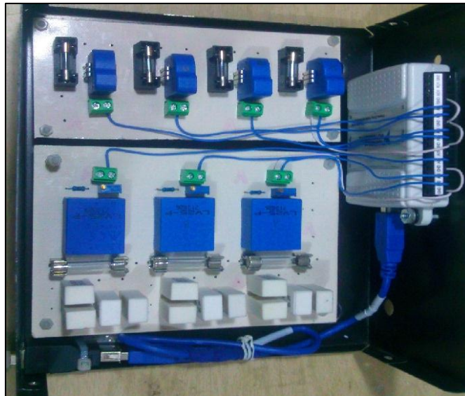
Imagen 4.15 Montaje de PCB's y DAQ en el Gabinete
