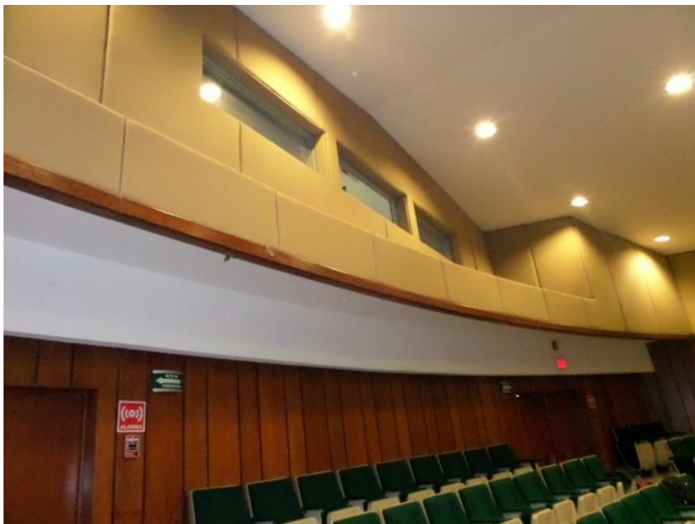
Figura 2.7. Vista de cabinas
