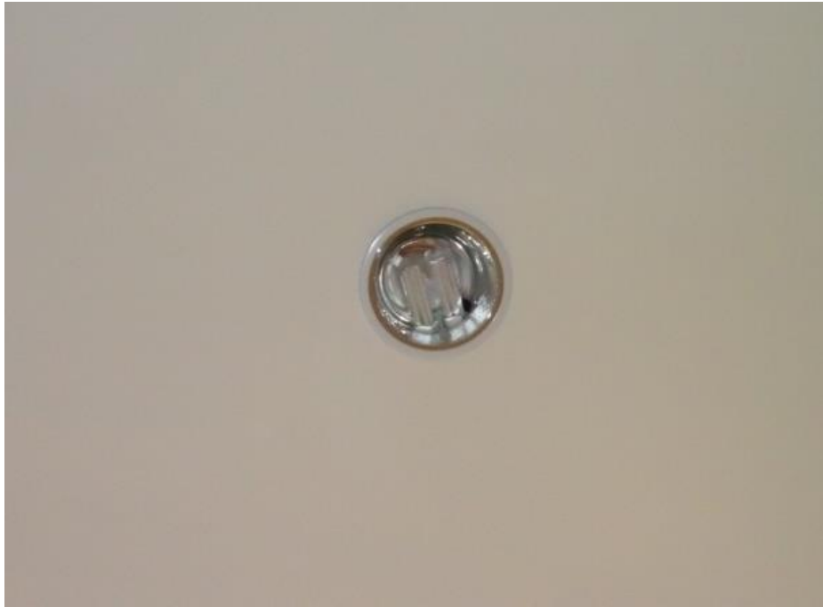
Figura 2.18. Iluminación del techo
