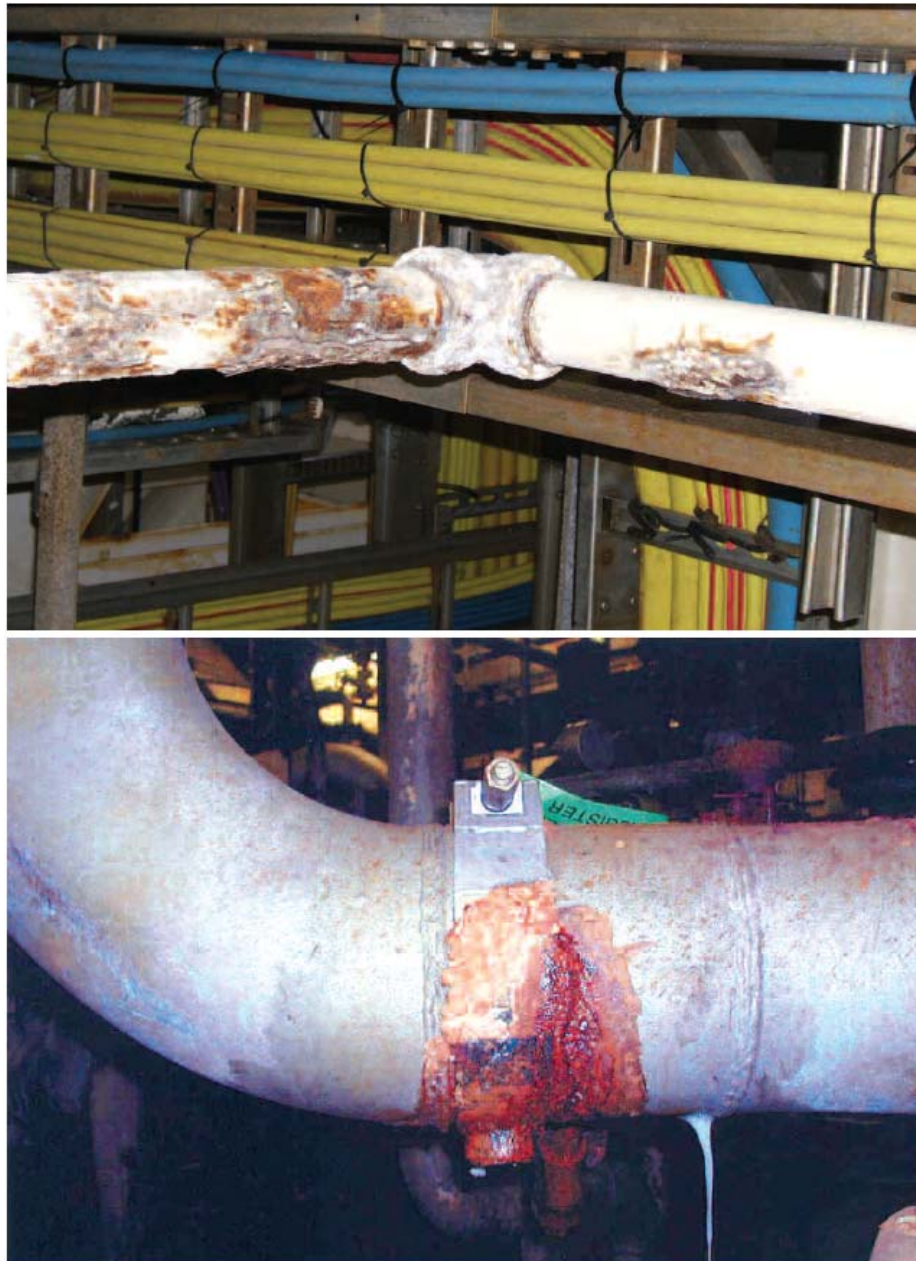
Figura K1. Ejemplos de corrosión en los equipos/instalaciones en una plataforma marina.
