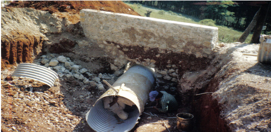
Ilustración No. VII.9. Obra de drenaje, alcantarilla transversal de lámina acanalada inoxidable y cabezote.
