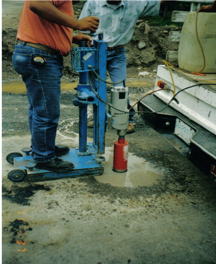
No. VI.31. Laboratorio haciendo el muestreo en la carpeta asfáltica, extrayendo corazones con máquina extractora.
