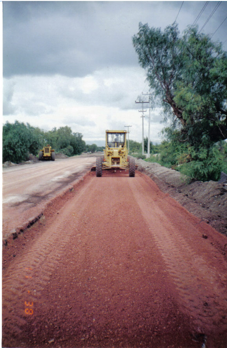
Ilustración No. VI.3. Tendido del material para subrasante en uno de los hombros del camino con la motoconformadora.
