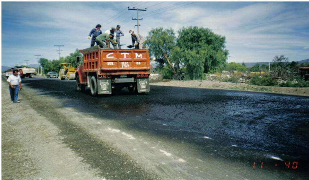
Ilustración No. VI.16. Realizando manto con mezcla asfáltica sobre el riego de liga para recibir la carpeta asfáltica.
