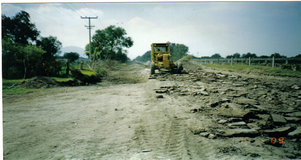
Ilustración No. VI. 1. Motoconformadora excavando abajo de la subrasante en los hombros y escarificando para levantar la carpeta asfáltica existente.
