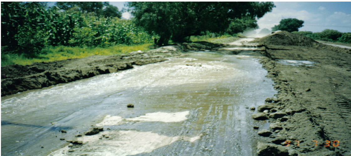
Ilustración No. VI.22. Efectos que causan las lluvias en el proceso constructivo, por no contar con un drenaje adecuado (cunetas).
