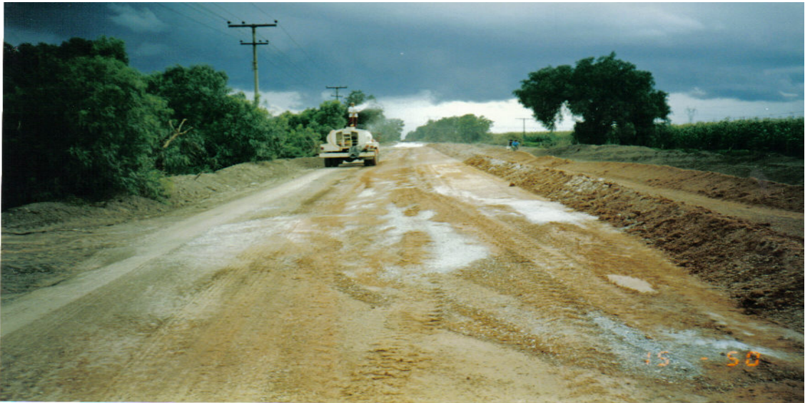
Ilustración No.VI.5. Humedeciendo materiales de las terracerías a través del camión pipa con motobomba.
