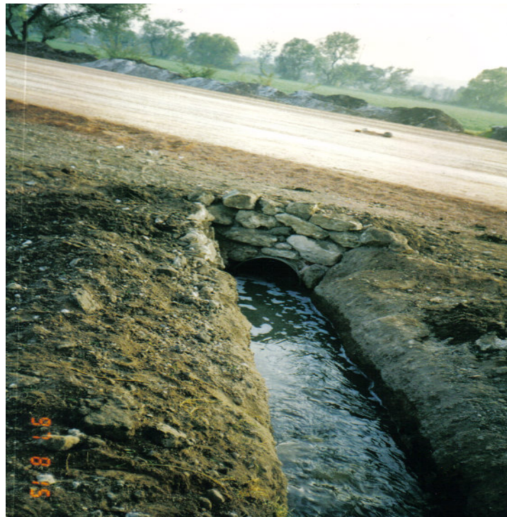
Ilustración. No. VI.24. Ampliación de las obras de drenaje necesarias para evitar destrucción en el camino.
