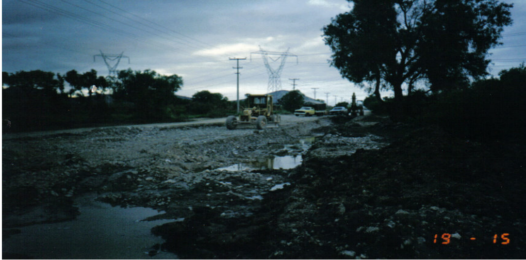
Ilustración No.VI.23. Efectos de deterioro causado por lluvias en los hombros del camino.
