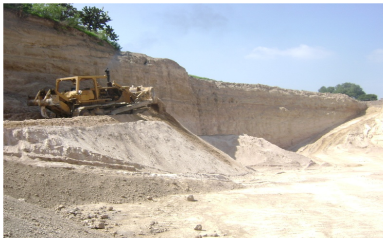
Ilustración No. III.5. Operación de abundar material en los bancos de materiales utilizables para terracerías.
