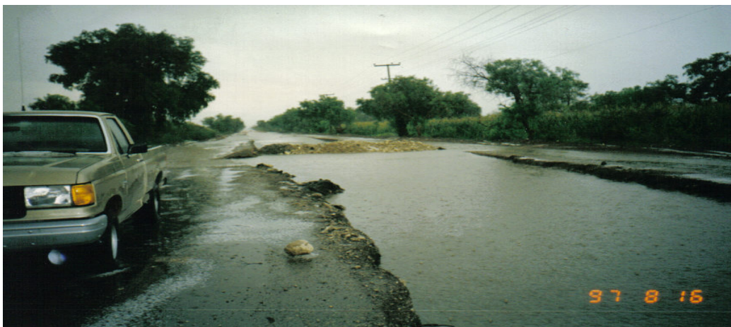
Ilustración No.VI.39. Efecto de la lluvia en la zona de la falla geológica.
