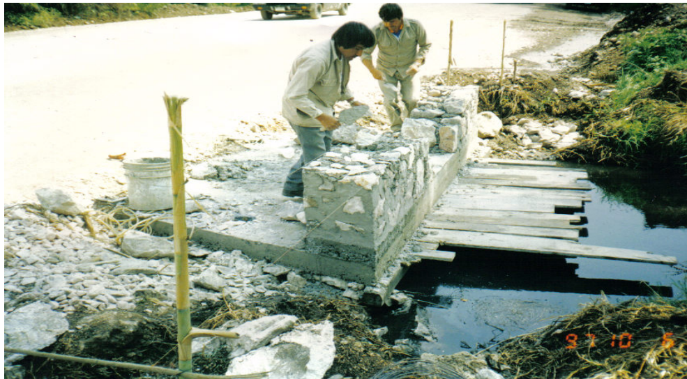
Ilustración. No.VI.26. Proceso constructivo de cabezotes de mampostería en la ampliación de las alcantarillas en las obras de drenaje.
