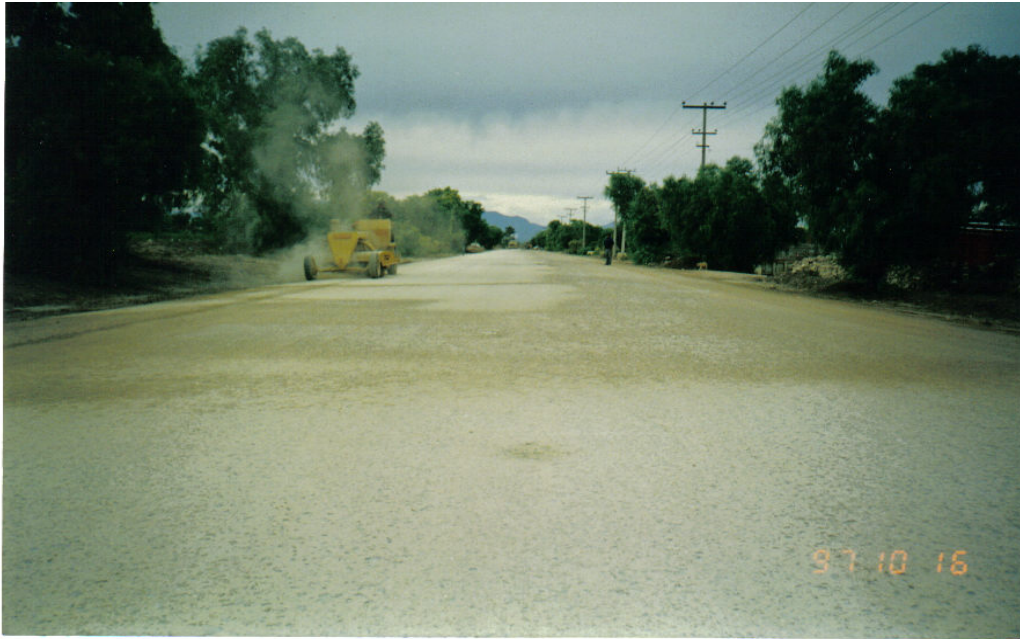
Ilustración No. IV. 12. Barredora mecánica; barriendo base hidráulica antes de aplicar el riego de impregnación.
