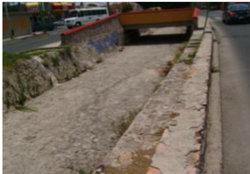
Dren de desfogue Fotografía tomada en sitio (Foto tomada en sitio)
