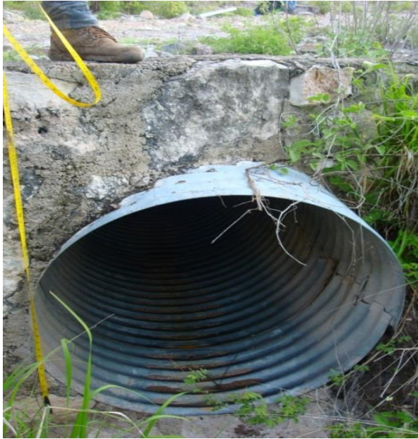
*Fotografía tomada en el sitio
