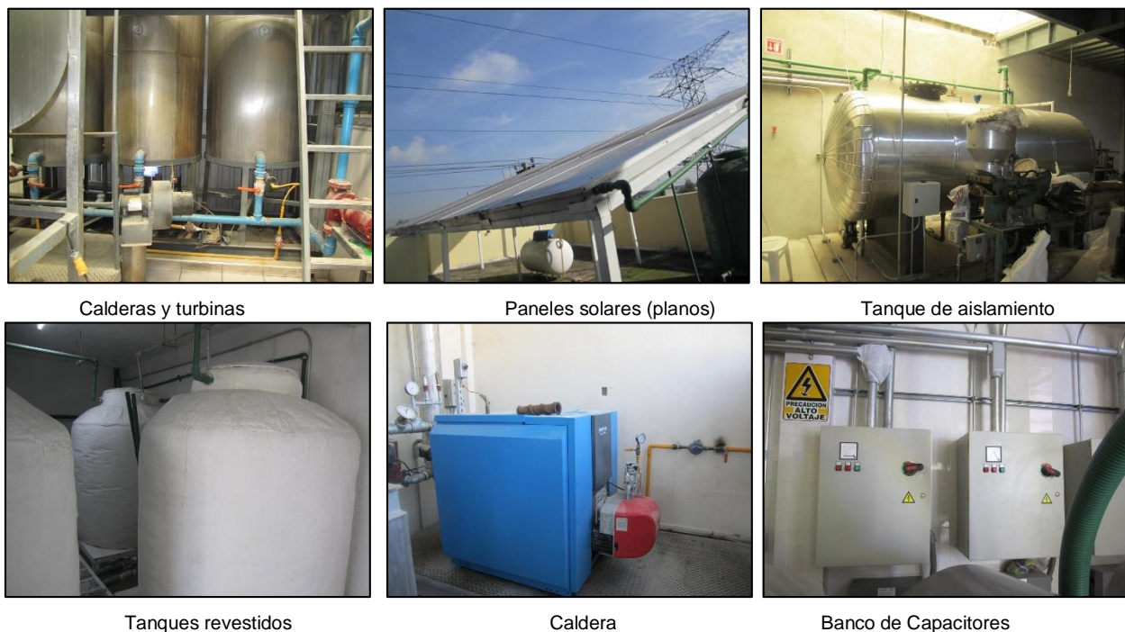
Figura 30. Instalaciones de los molinos más eficientes.
