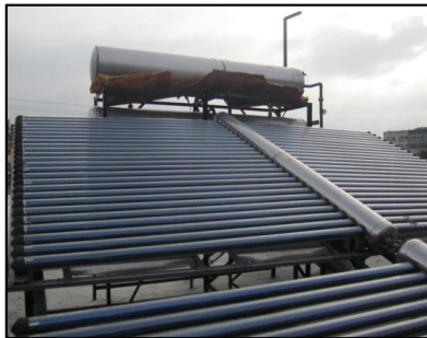
Paneles solares (tubos evacuados)
