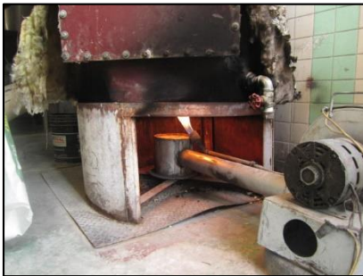
Calderas y turbinas
