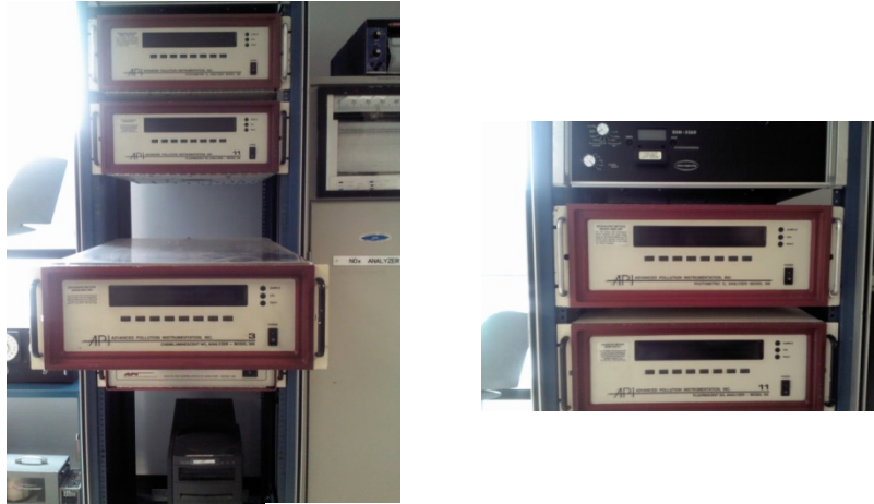
Figura 0.1 Rack de aparatos de medición.
