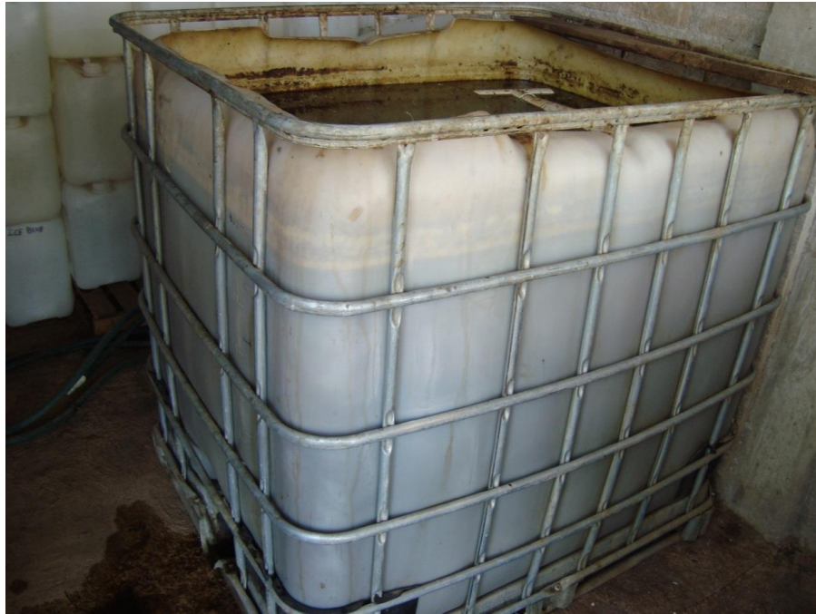
Figura 78 Tanque de almacenamiento de las Sustancias Húmicas
