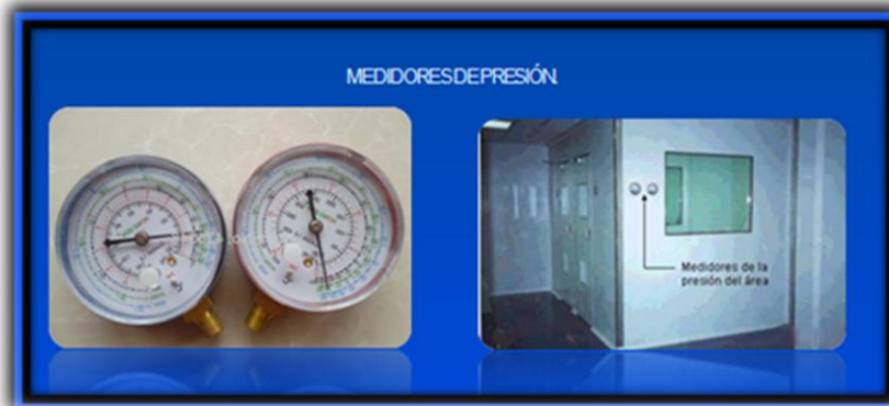
Figura I.10. Medidores de presión
