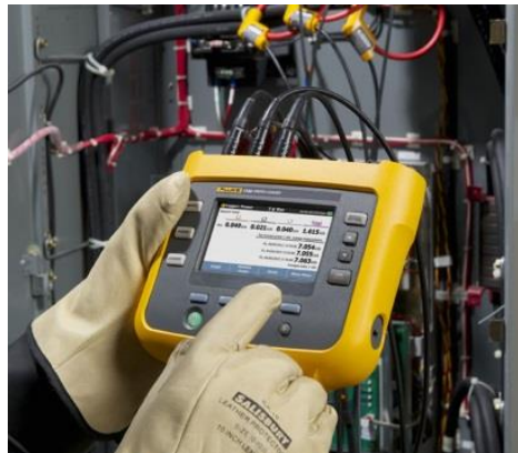
Figura 4.2 Mediciones Eléctricas en el Tablero Principal Fuente: Elaboración Propia.
