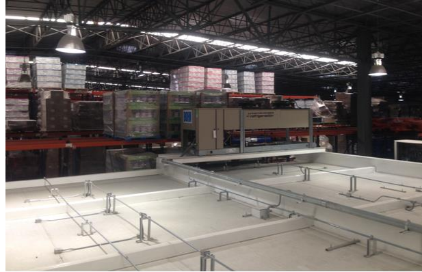
Figura 4.11 Cámara de Refrigeración
