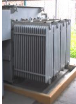
Figura 4.3 Imagen del Transformador Principal
