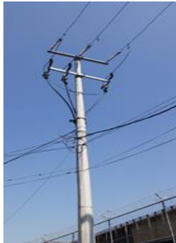
Figura 2.3 Acometida de la Empresa Láctea. Fuente: Elaboración Propia
