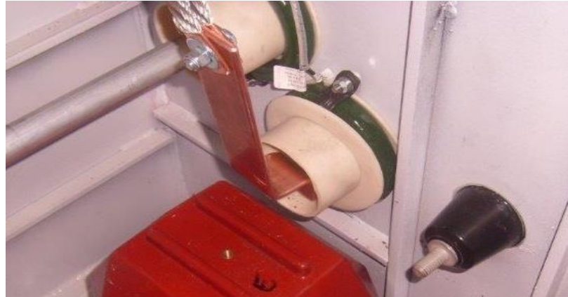
Figura 33. TC'S en el interior del tanque.
