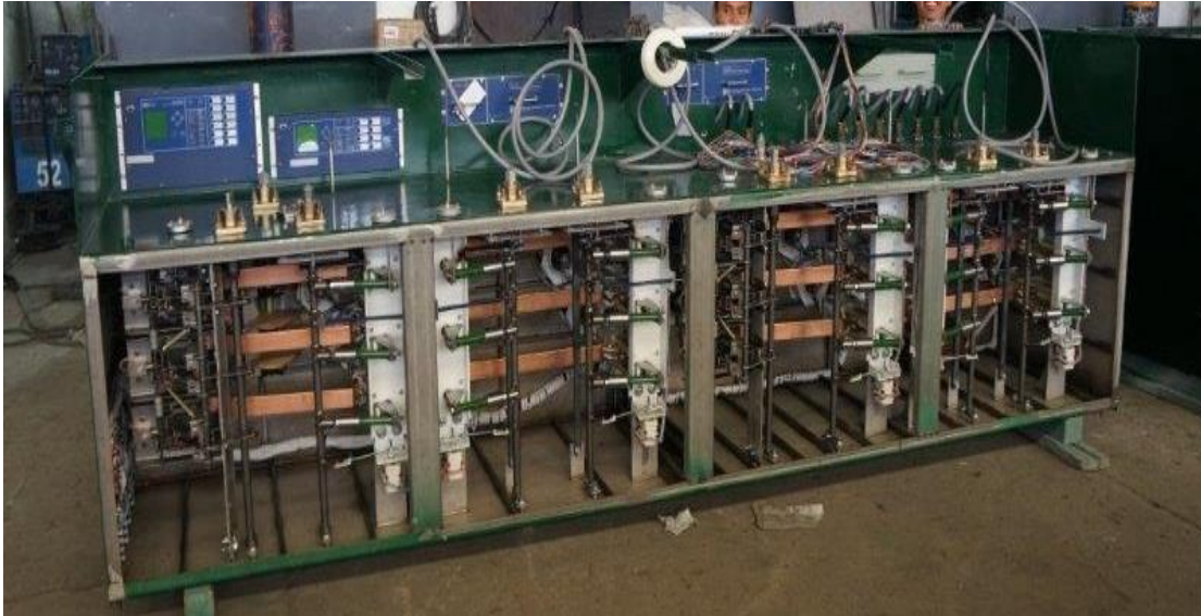
Figura 36. Seccionador en etapa final de pruebas.
