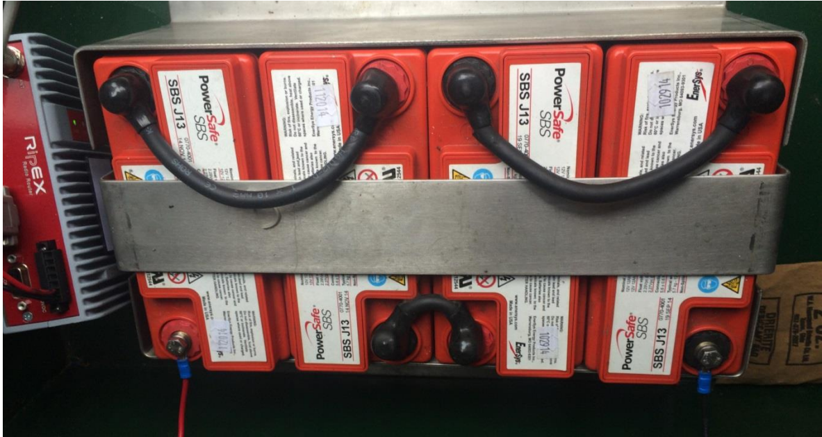
Figura 38. Baterías que conforman la UPS.
