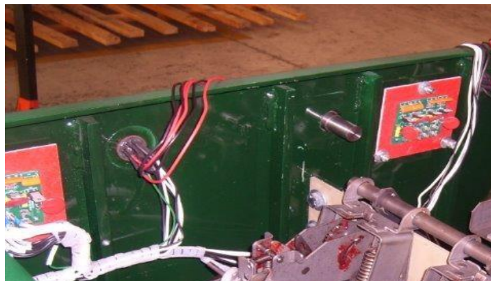
Figura 34. Tarjeta cortocircuitadora de los TC'S.
