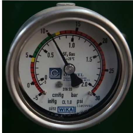
Figura 20. Densímetro indicador para un seccionador de operación manual.
