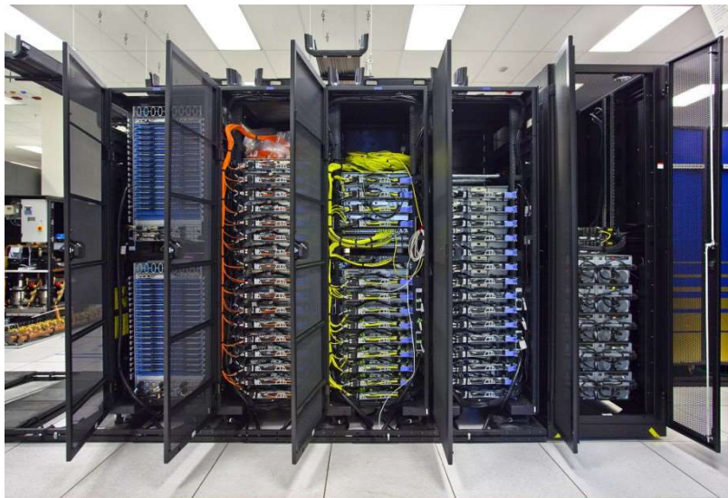
Figura 3.6. Cuarto de comunicaciones
