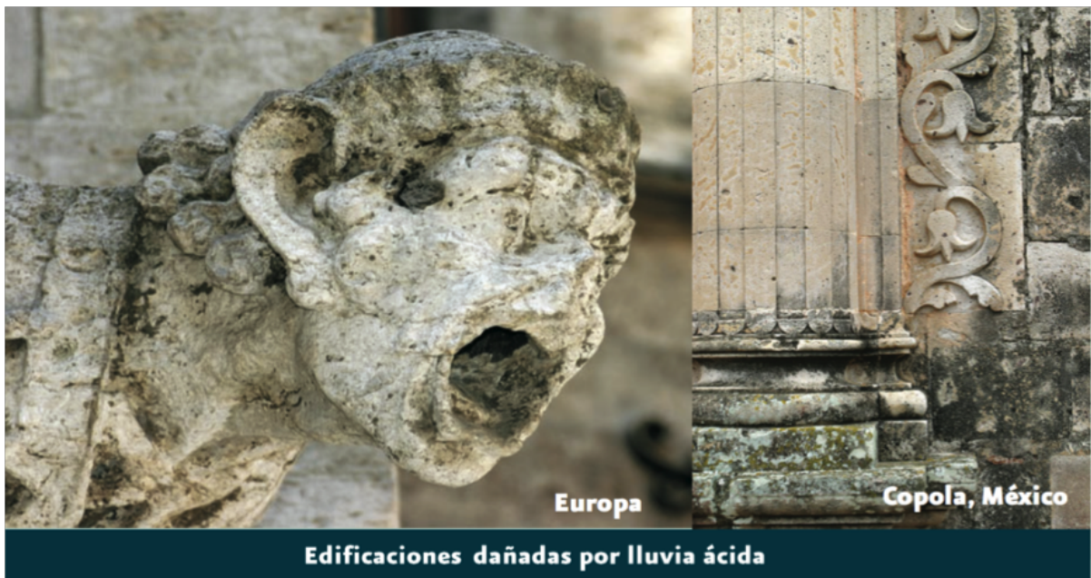
Figura 2.10: Daños en edificaciones por lluvia ácida.
