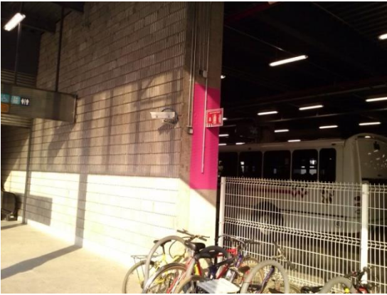
Cámara de Vigilancia ubicada en Patio de Maniobras con vista a escaleras de acceso
