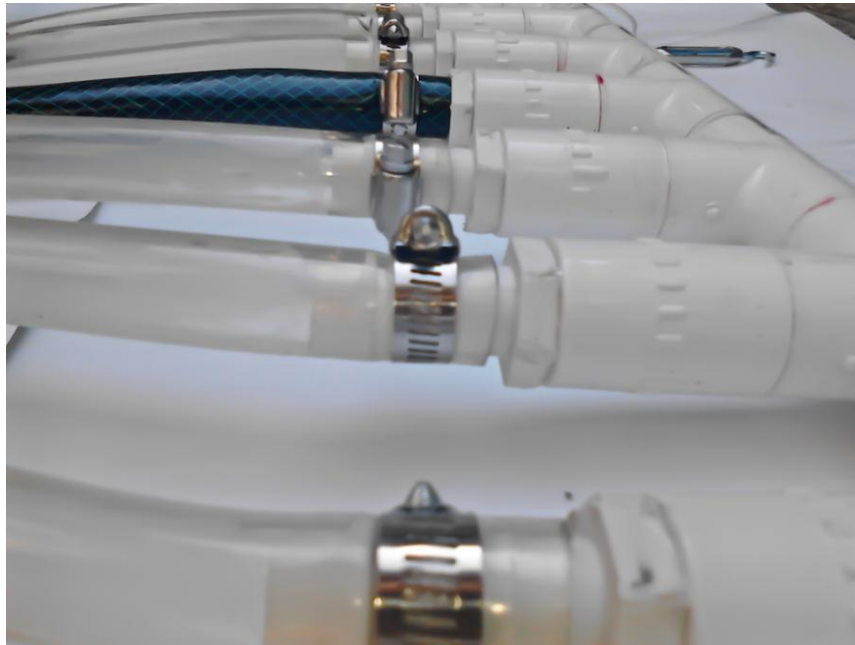
Figura 28. Piezas de tubería ensambladas a detalle.
