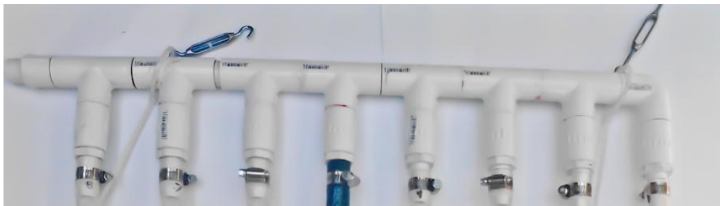
Figura 27. Estructura de distribución de agua.
