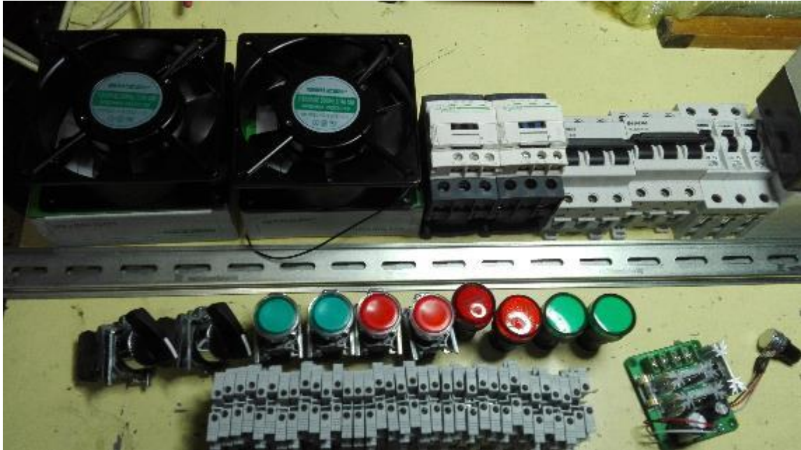
Figura 4.4 Material empleado para el ensamble del gabinete de control
