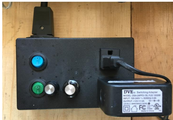
Figura 4. 40 Caja de controles del sistema de enfriamiento, arrastre y enrollado
