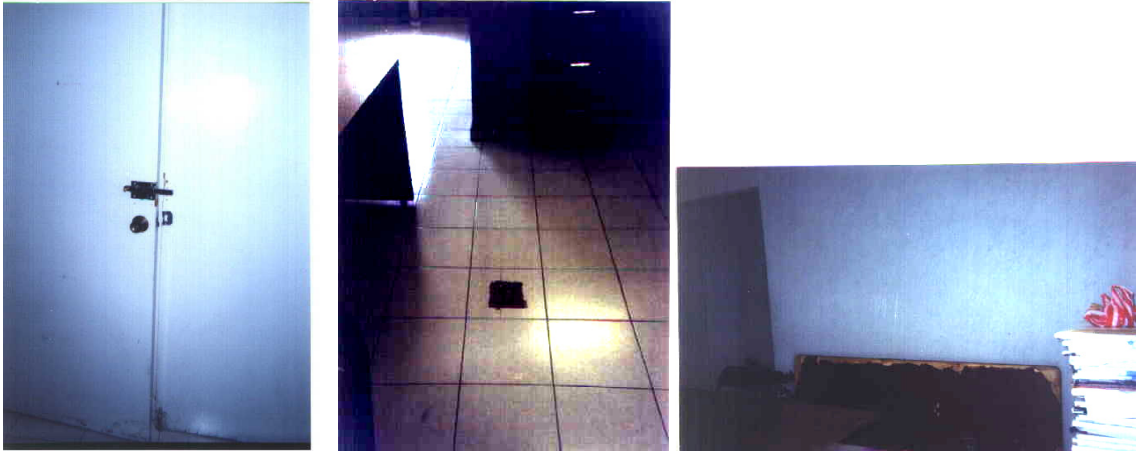
Figura 3.5 Equipo en mal estado. De izquierda a derecha: Chapa de una puerta de acceso a las oficinas, inservible; contacto en el piso en mal estado tapado con cinta canela ; al fondo un tablón en mal estado y a lado un montón de propaganda caduca basura.
