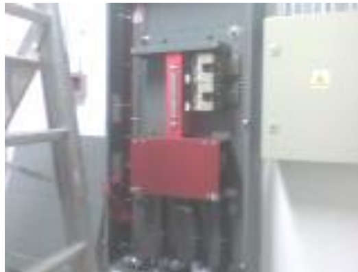
Figura 14 interruptores del PCDU
