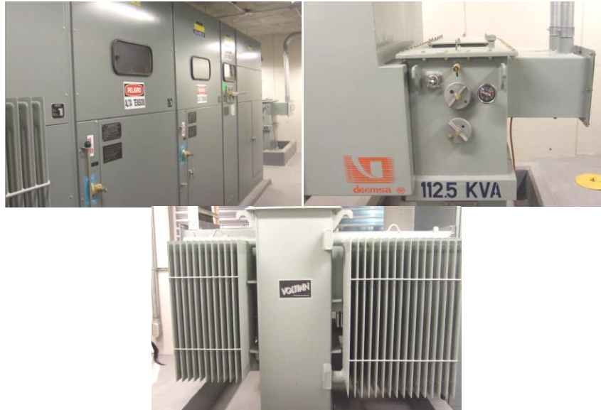
Figura 11 Subestación eléctrica y elementos que la integran
