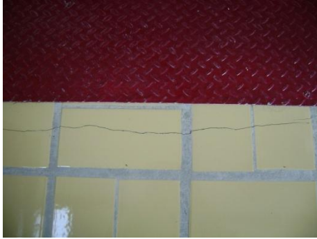
Fotografía No. 16.- Algunas de las fisuras de las nuevas instalaciones (corredor).
