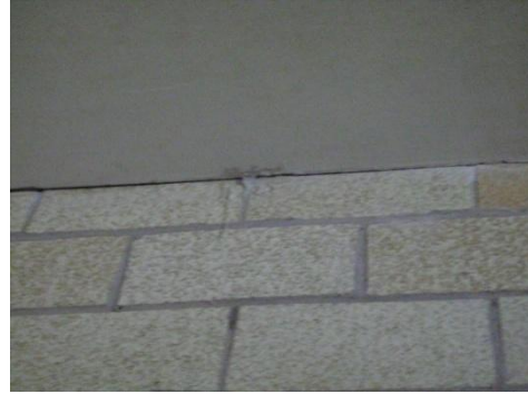
Fotografía No. 17.- Fisuras generadas en los techos
