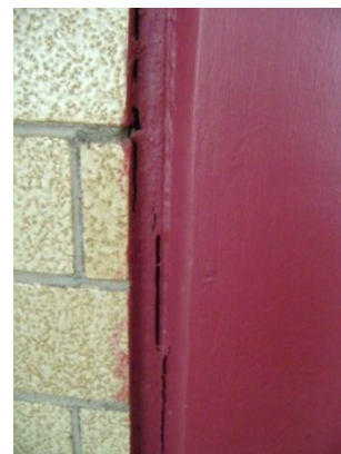
Fotografía No. 19.- Fisuras hechas en las columnas
