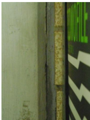
Fotografía No. 18.- Fisuras hechas en las instalaciones anteriores
