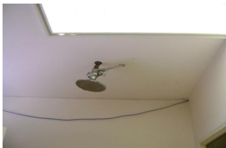
Fotografía No. 1.- Regadera sin tubería
