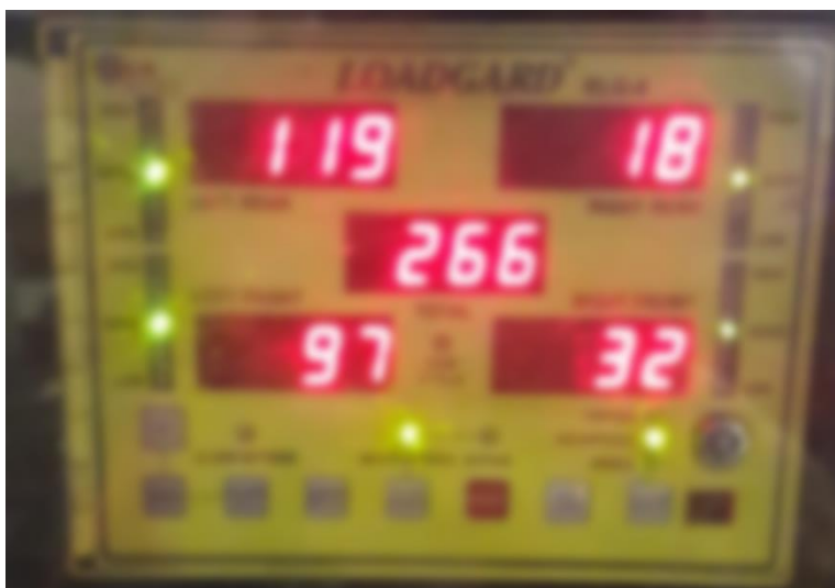
Figura 59. Monitor de tonelaje en mal estado.
