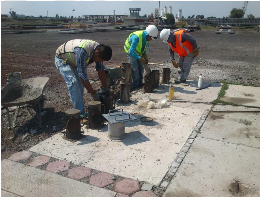
Ilustración 98. Para comprobar la resistencia a compresión del concreto en estado endurecido; laboratorio LACOCS y de planta, realizan el llenado de 5 moldes, cada 40m 3 para los especímenes a ensayar de acuerdo a la norma NMX-C-083-1997-ONNCE.
