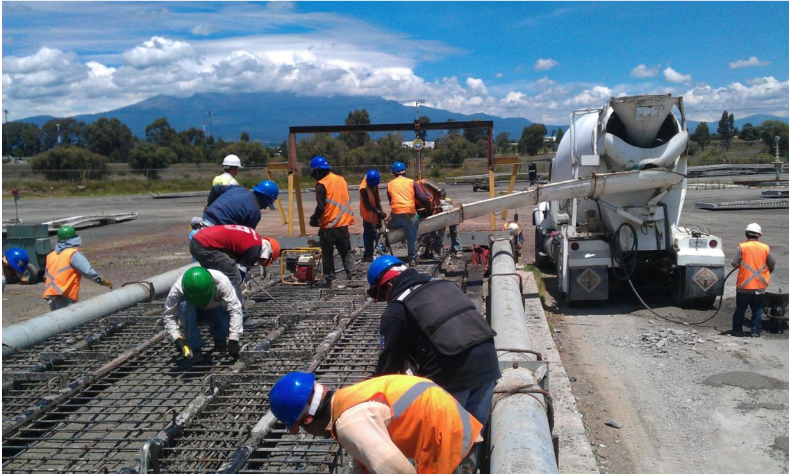
Ilustración 97. Durante el colado, superviso la forma de colocación, acomodo y compactación del concreto fresco en capas, los tiempos de descarga, los cuales no deben superar 90 min. desde que se le agrega el agua, hasta el término de descarga y su trabajabilidad.
