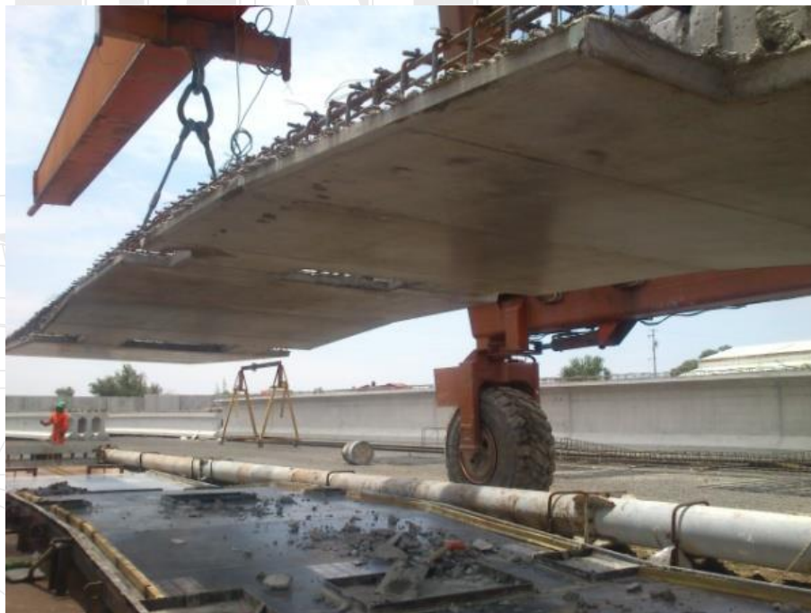
Ilustración 121. Una vez extraída la prelosa de molde, supervisaba el acabado inferior de la losa, para identificar posibles desprendimientos de concreto.
