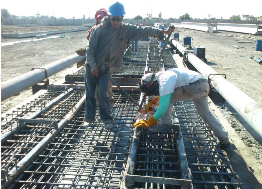
Ilustración 86. Troquelado de peines metálico, superviso su alineación y que no esté dañado ningún torón por la soldadura.
