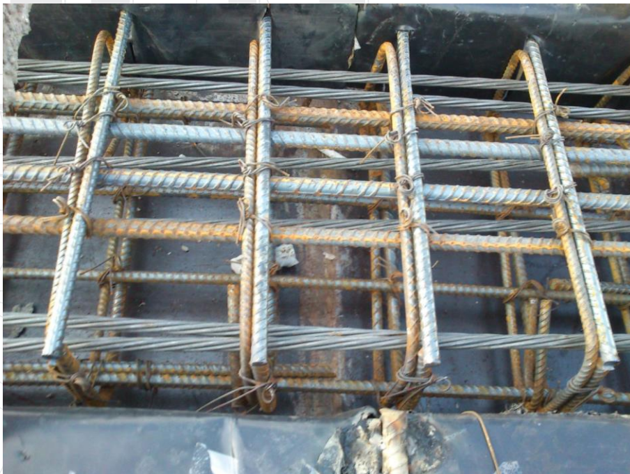
Ilustración 90. Si durante el tensado, los torones se trenzan; estos deben destensarse y corregir la trayectoria de los mismos.
