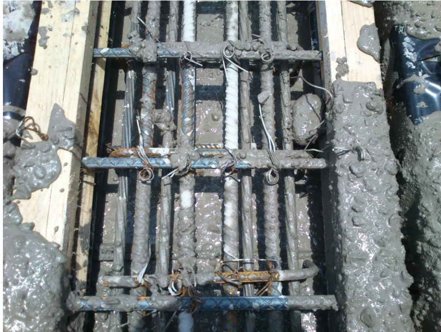
Ilustración 101. Los grumos por falta de mezclado en el diseño de concreto, deben ser retirados.
