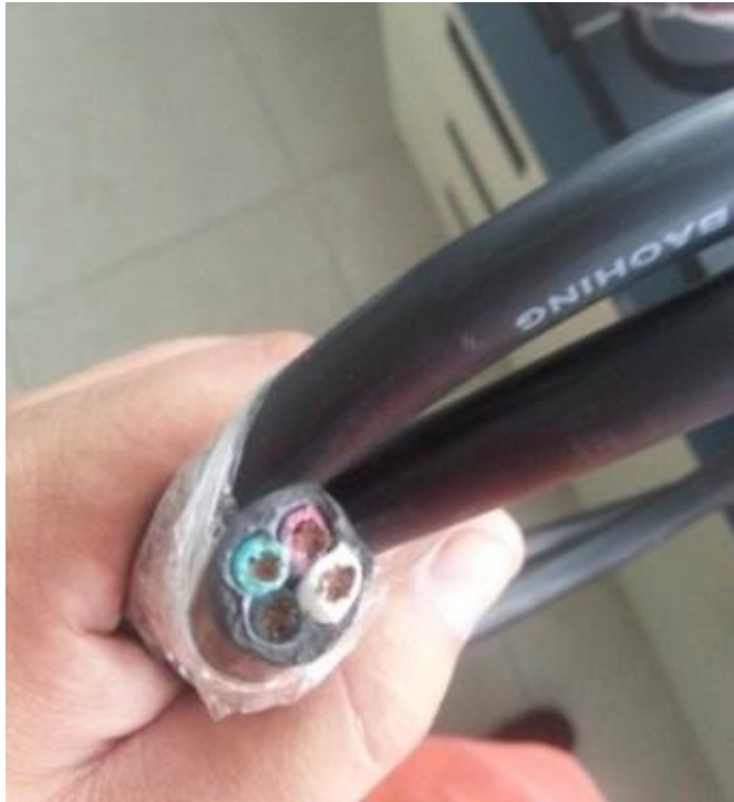
Figura 20. Cables sin conexiones.
